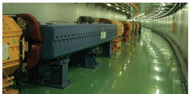
トンネル中に設置された50 GeVシンクロトロン電磁石
