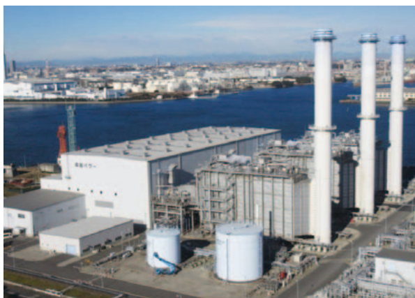
1 扇島パワーステーションの全景
