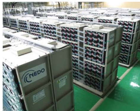
13 伊豆大島に設置されたLL-G型鉛蓄電池設備
