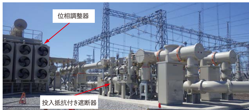
5 位相調整器および投入抵抗付き遮断器
