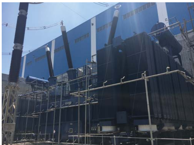
3 運用開始後の変圧器
