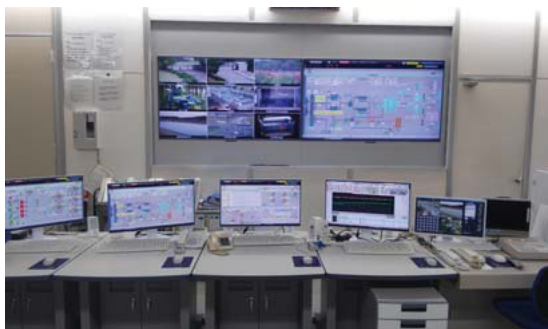
2 県中央水道事務所（水戸浄水場）の中央監視制御設備
