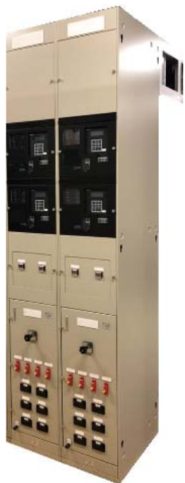
6 電流差動リレー装置外観
