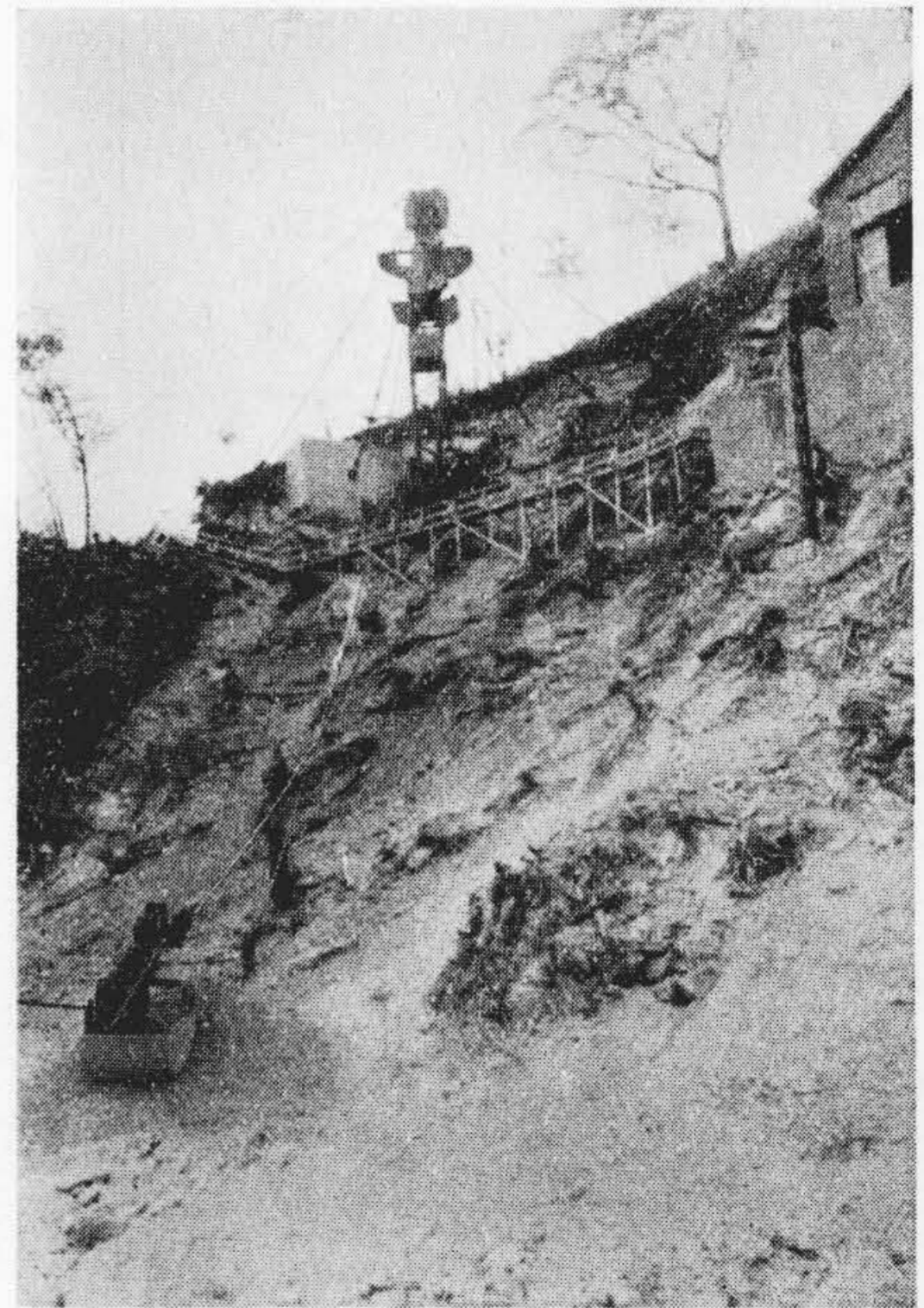
第6図 2 m 3 固定式タワーエクスキャベータ Fig. 6. 2 m 3 Fixed Type Tower Excavator
