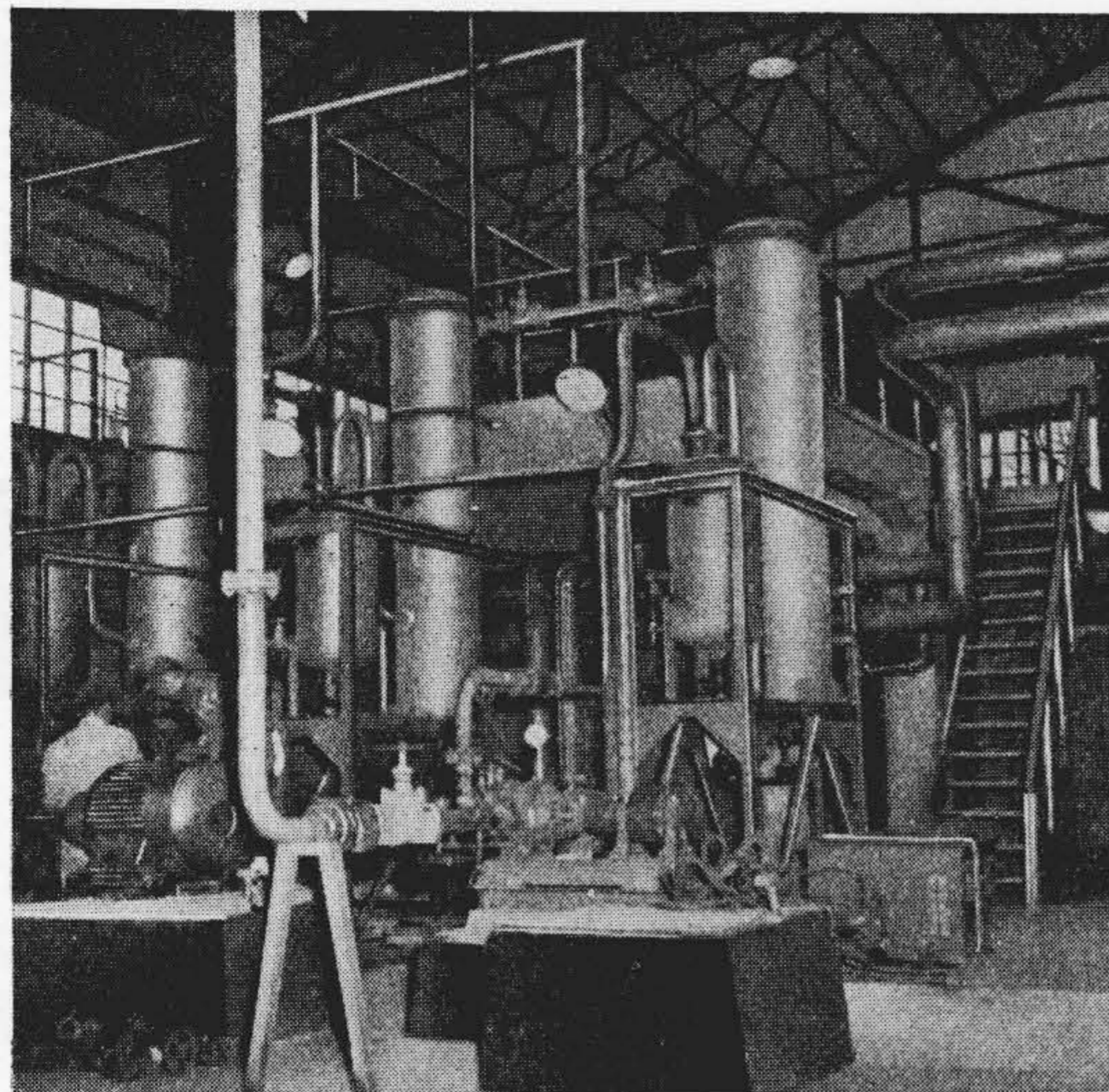
第18図 塩素液化装置 圧力 2 kg/cm 2 能力 6 t/Day Fig. 18. Liquefaction Plant of Chloride Pressure 2 kg/cm 2 Capacity 6 t/Day
