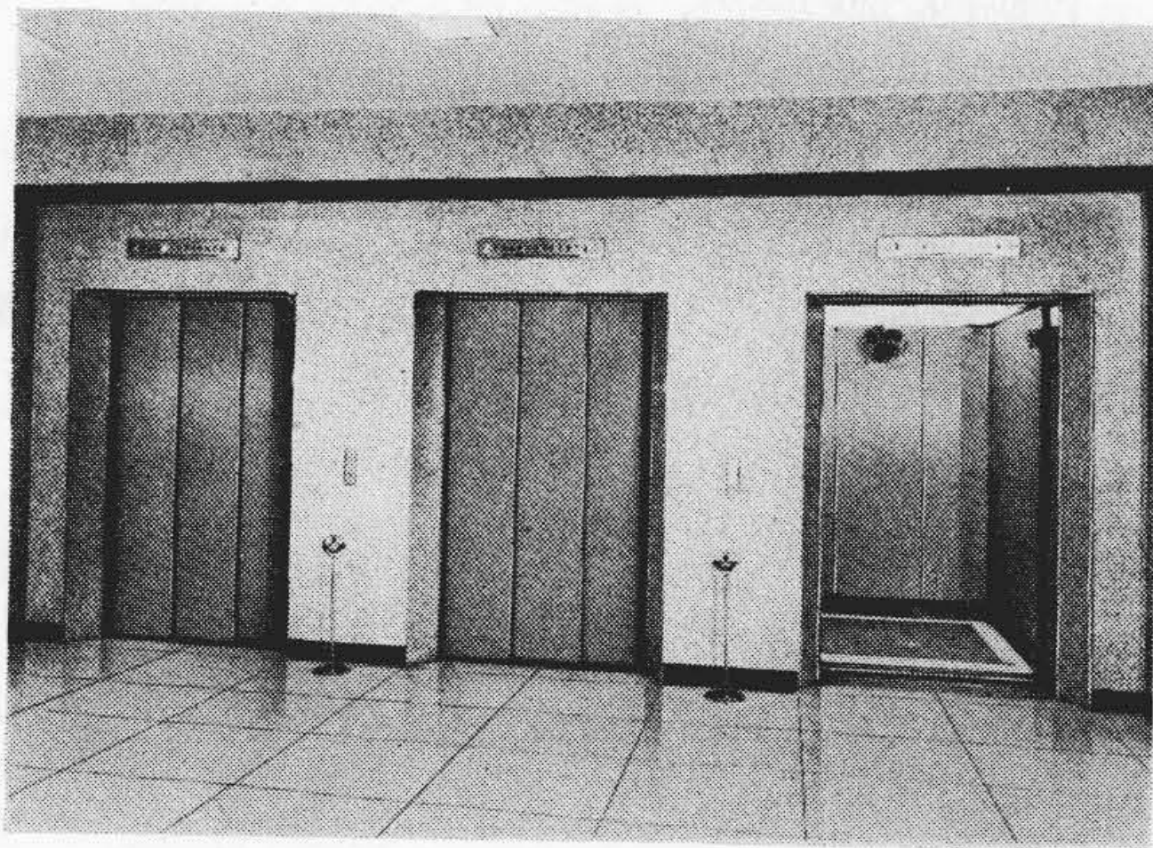
第47図 日本興業銀行納 直流可変電圧ギヤレス レコードコントロールエレベータ Fig. 47. Nippon Kōgyō Bank (D.C.V.V. Gearless Record Control Elevator)
