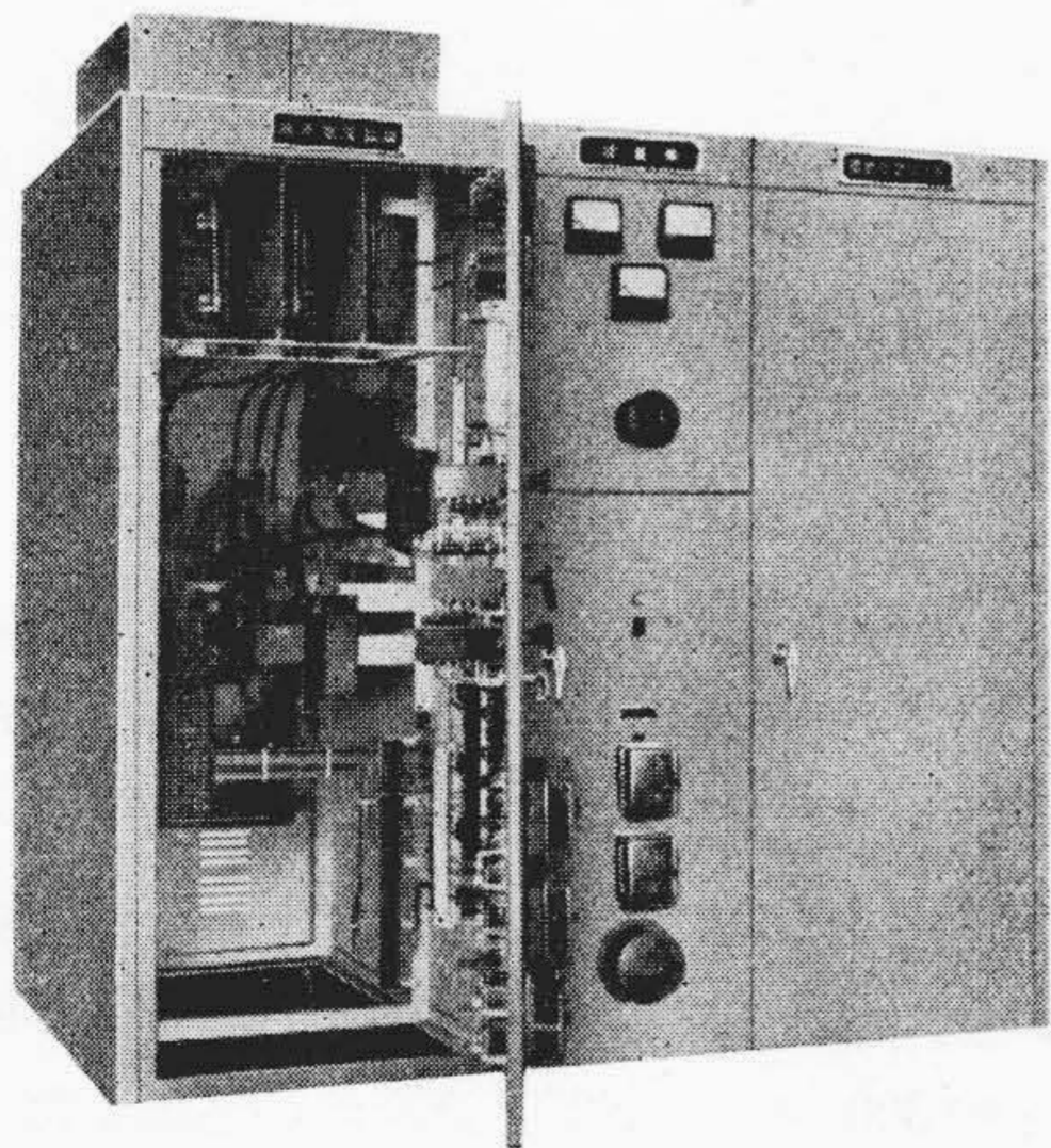
第 34 図 超同期電動機自動起動制御用キュービクル
