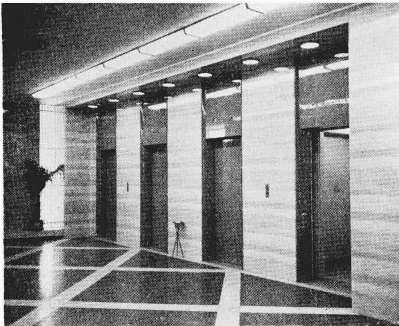
第52図 呉服橋ビル納 オーダリーシグナル コントロールギャレスエレベータ Fig.52. Orderly Signal Control Gearless Elevator for Gofukubashi Building
