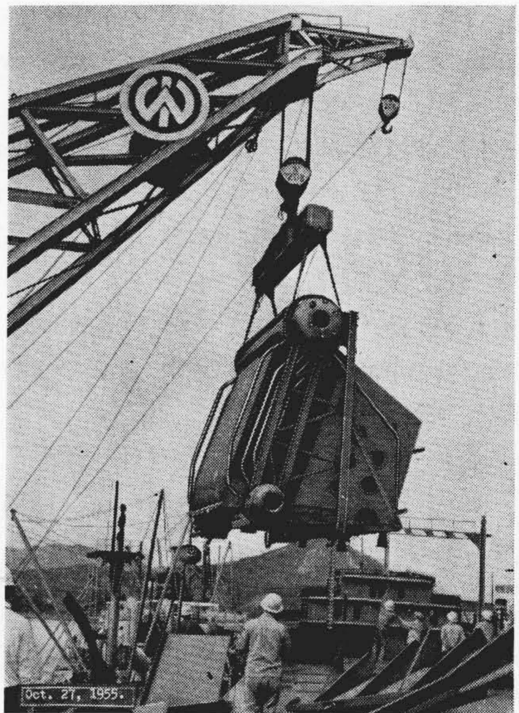
第9図 120 t 海上クレーンによるボイラの積込作業 Fig. 9. Loading of Boiler with 120-ton Floating Crane
