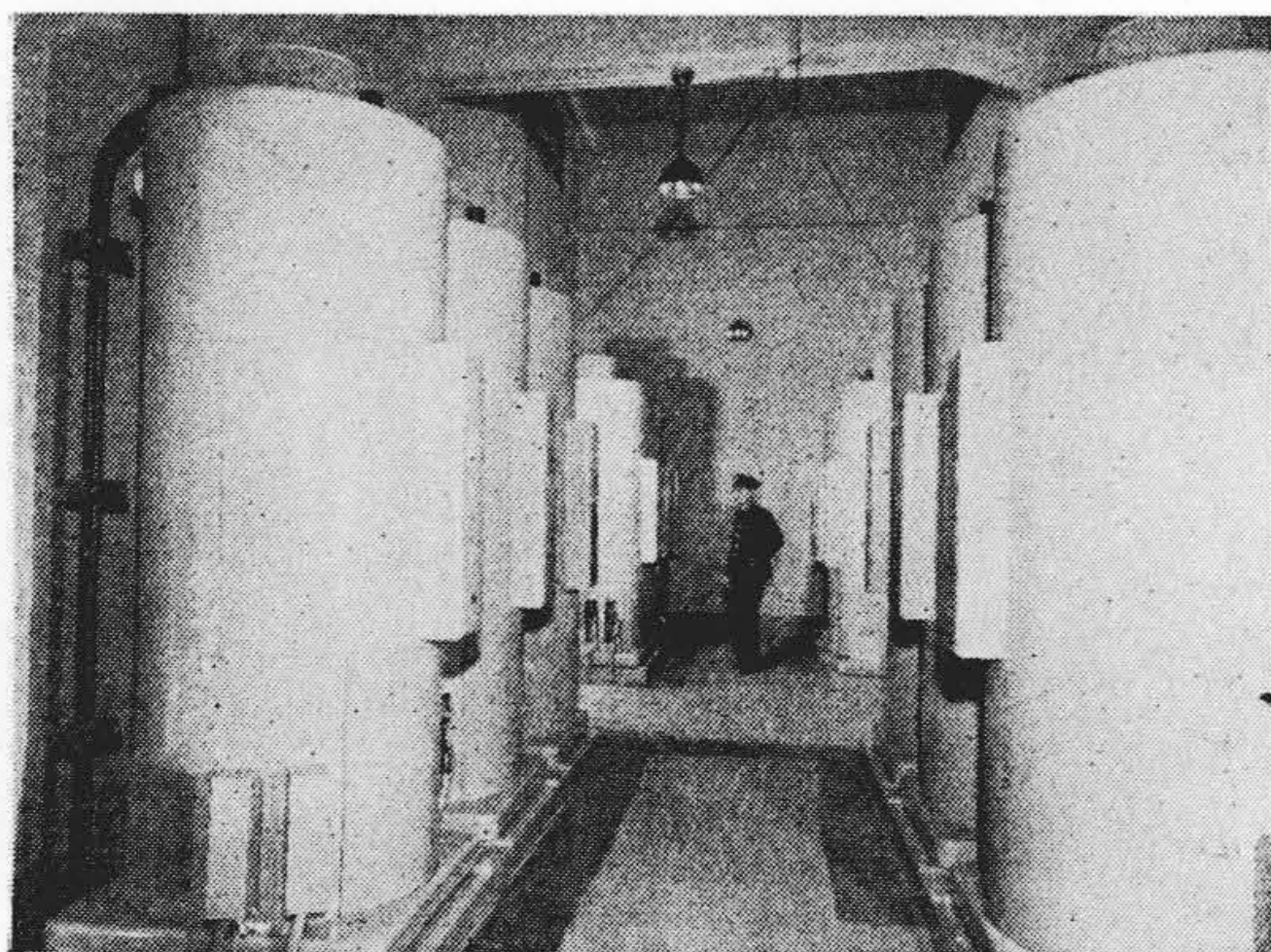
第 32 図 国鉄信濃町変電所 3000 kW/1500 V E 種定格封じ切り風冷エキサイترون
