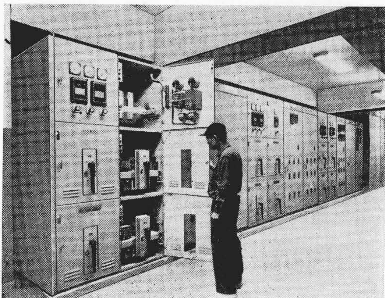
第 10 図 東北電力株式会社上野尻発電所納 低圧メタルクラッド
