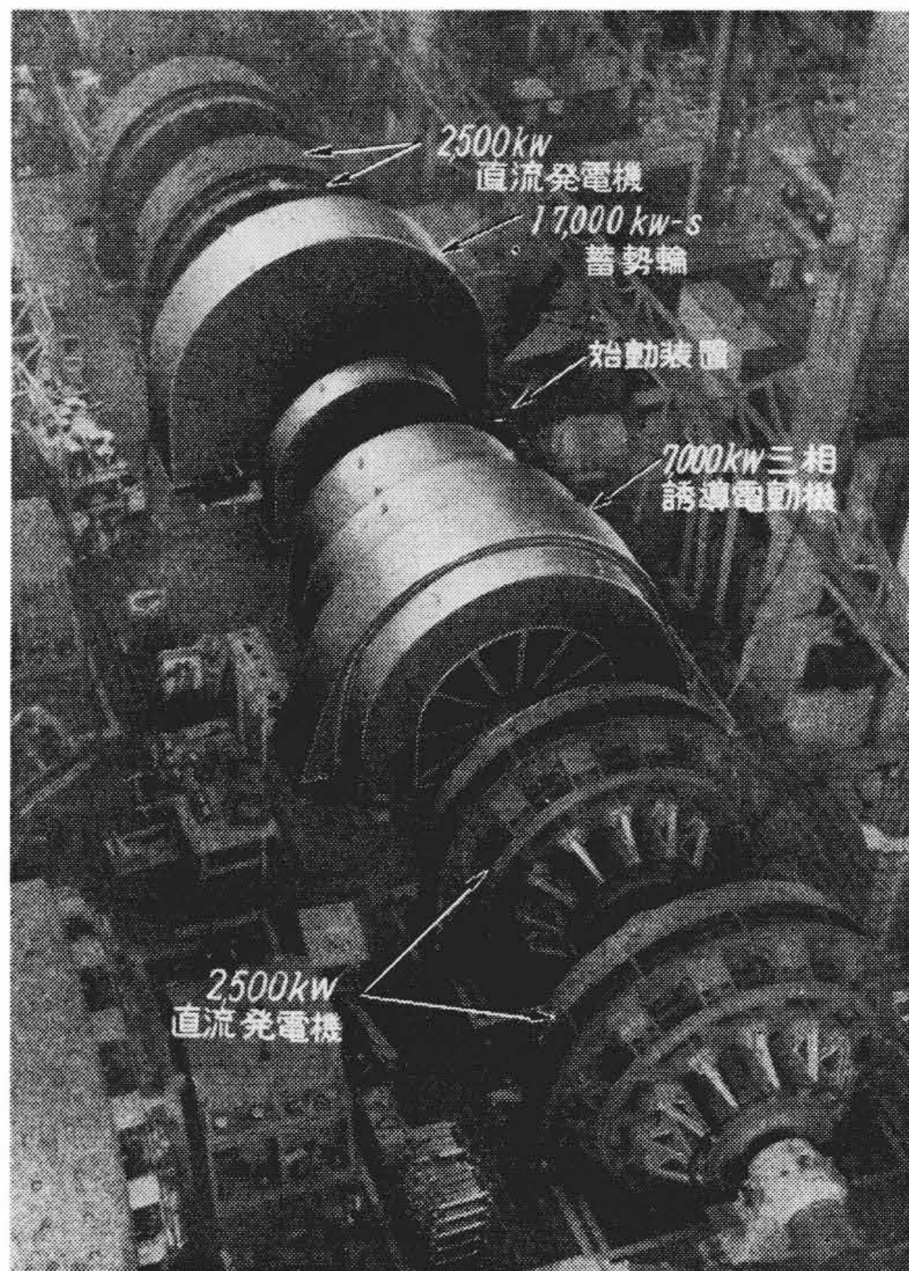
第14図 10,000kW イルグナ変流機外観
