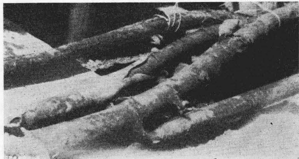
第5図 特殊溶剤に接触したネオプレンシースケーブルの膨潤劣化状態
