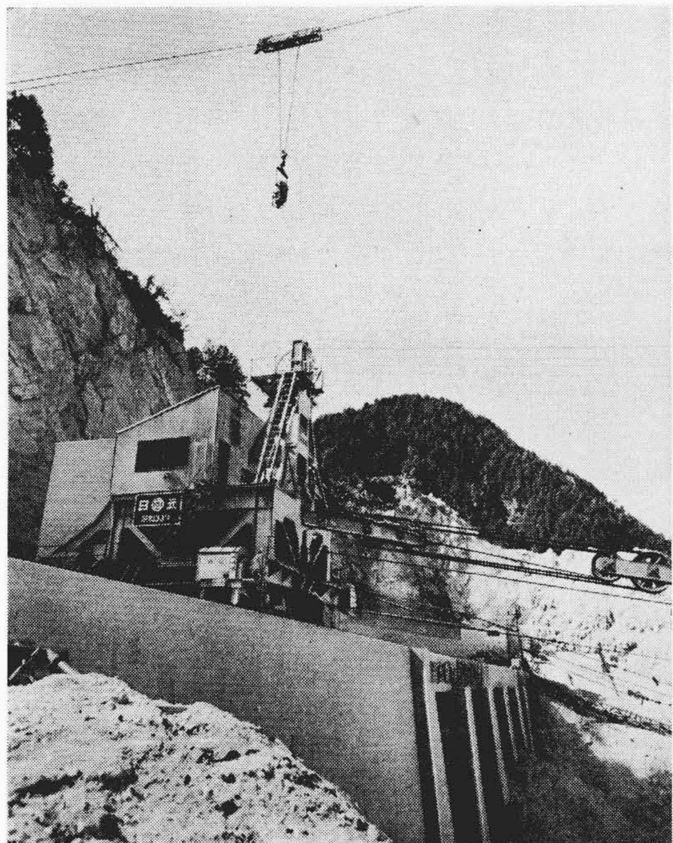
第13図 25 t ケーブルクレーンテールタワー
