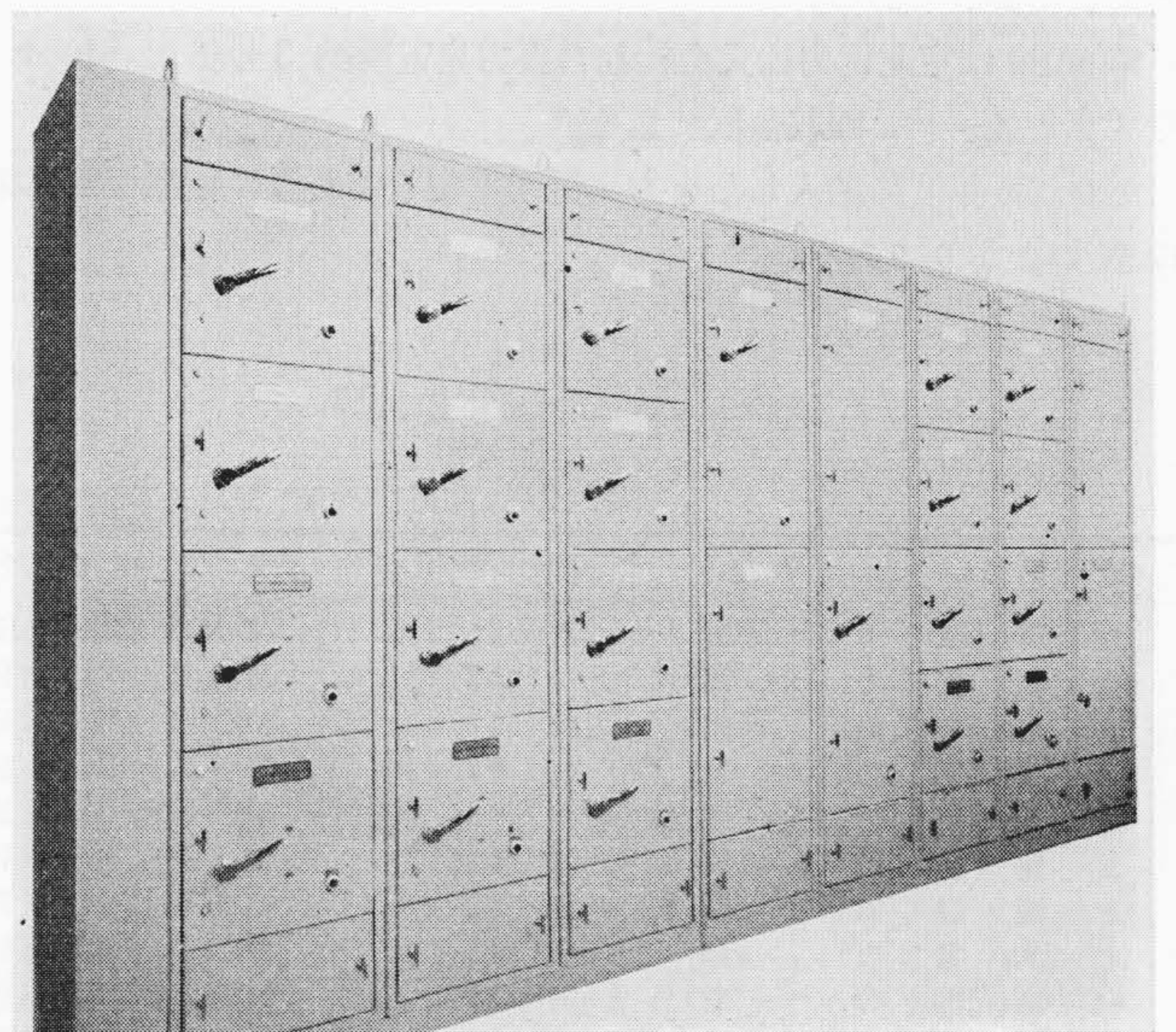
第 53 図 コントロールセンター外観
