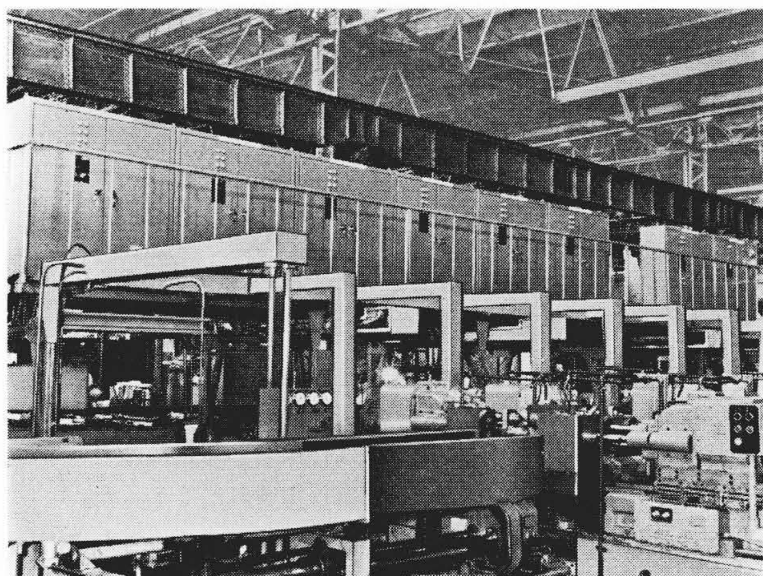
第13図 上部に設置された電気制御盤
