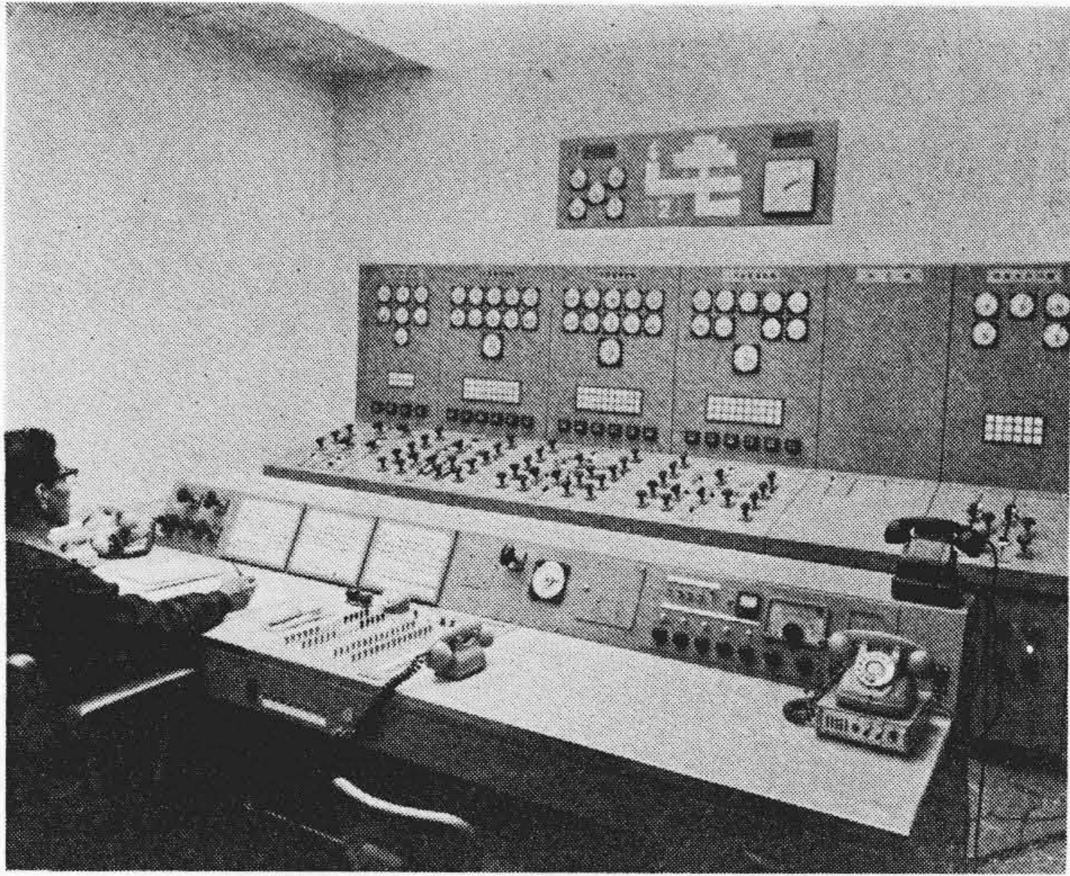
第13図 畑薙第一発電所主配電盤
