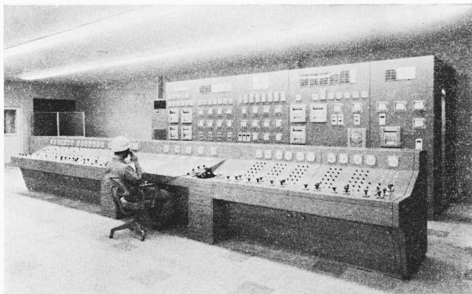
第 23 図 東海製鉄株式会社納 11,000 Nm 3 /h TO プラント用中央計器盤および中央制御卓
