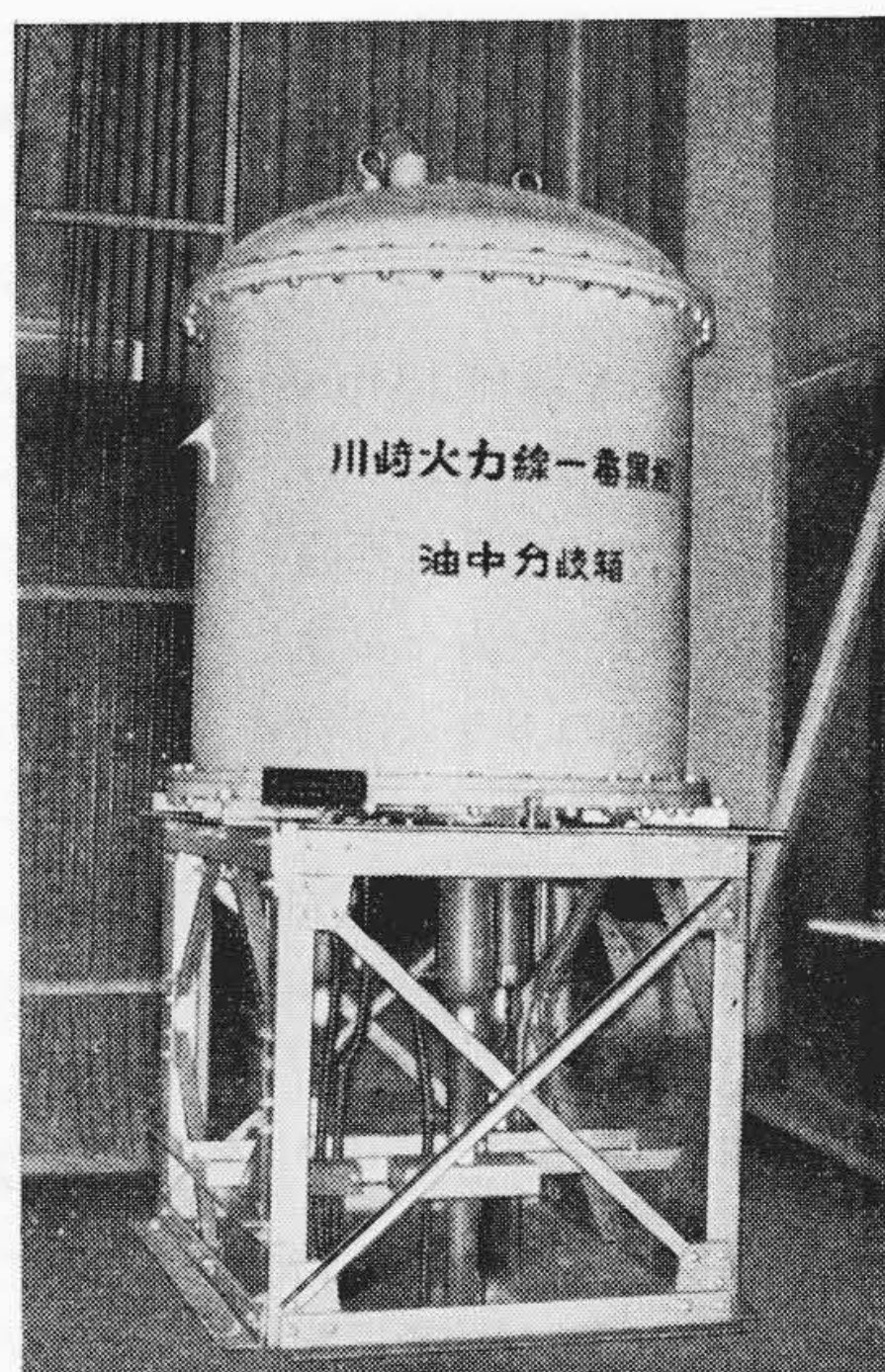
第7図 140 kV 油中分岐箱
