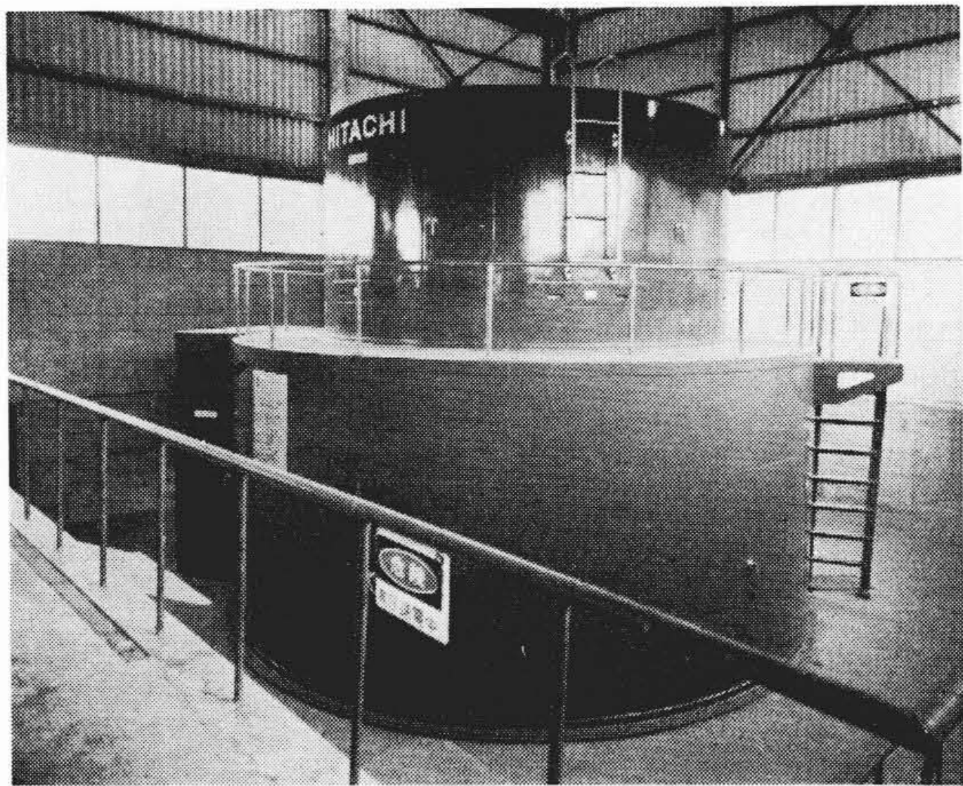
第7図 6,200 kW クレーマセット
