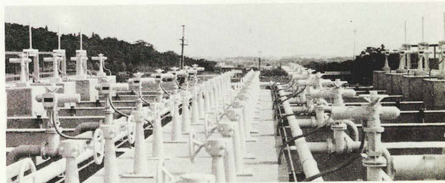
図45 日立ハイフィルタ(急速ろ過池)
