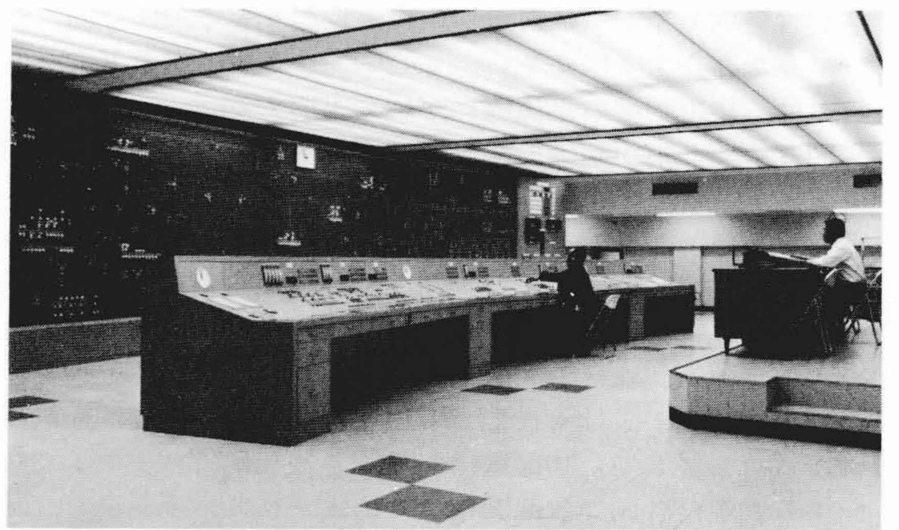
図5 変電所集中制御所 集中制御監視室には系統盤、制御卓及び指令卓が設置されている。
