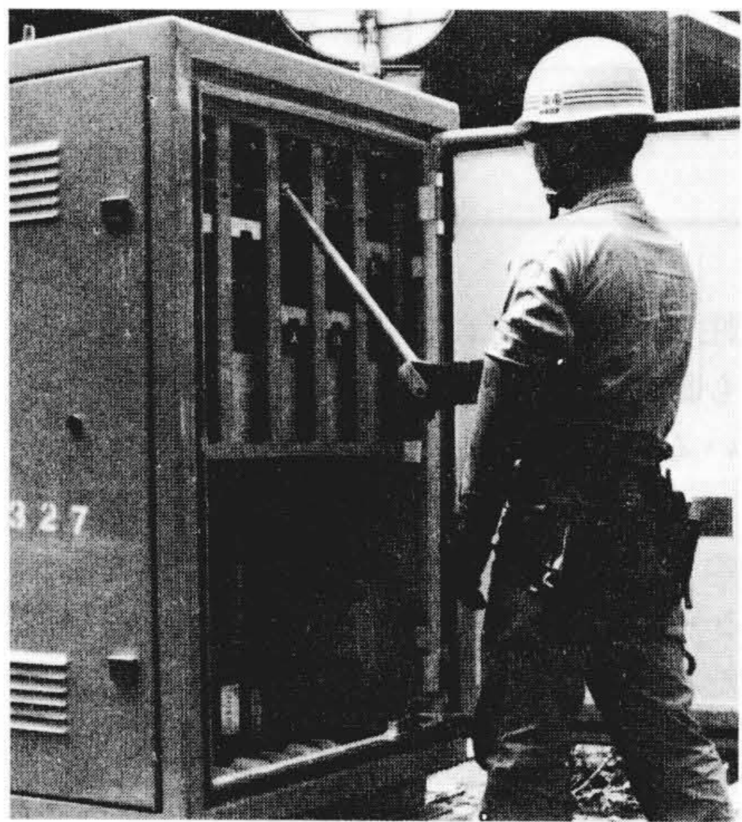
図1 気中多回路開閉器操作状況
