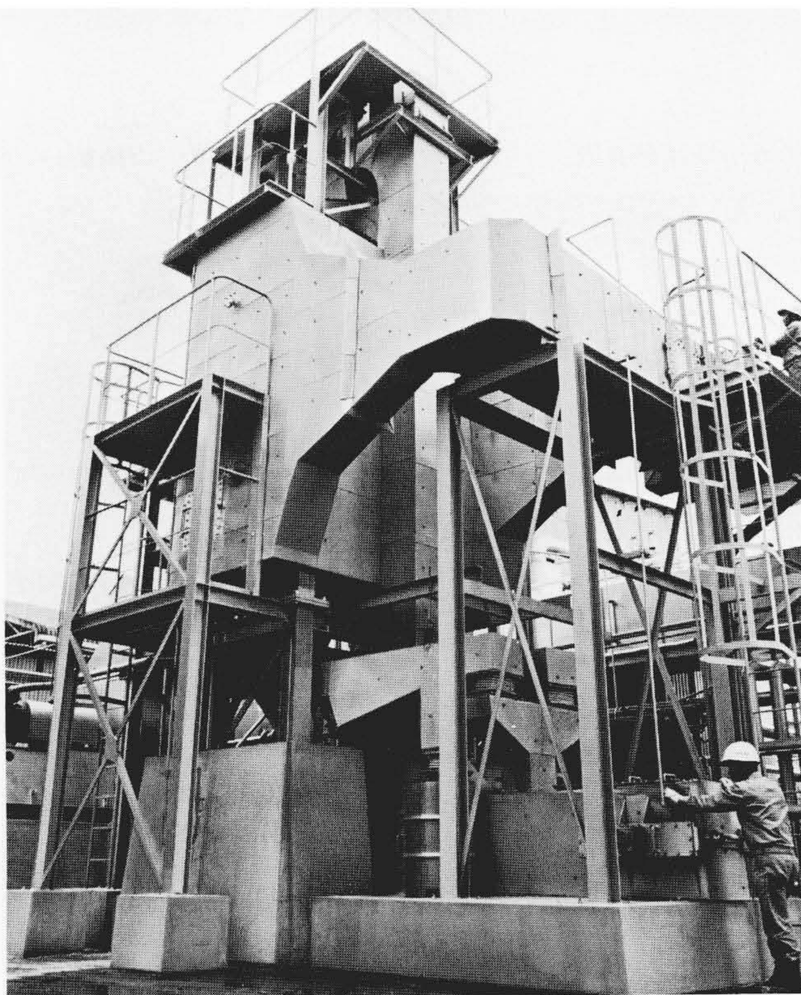
図2 千代田建材工業株式会社貝塚工場納め 15,000\text{Nm}^3/\text{h} 重油だきボイラ用排ガス脱硝装置
