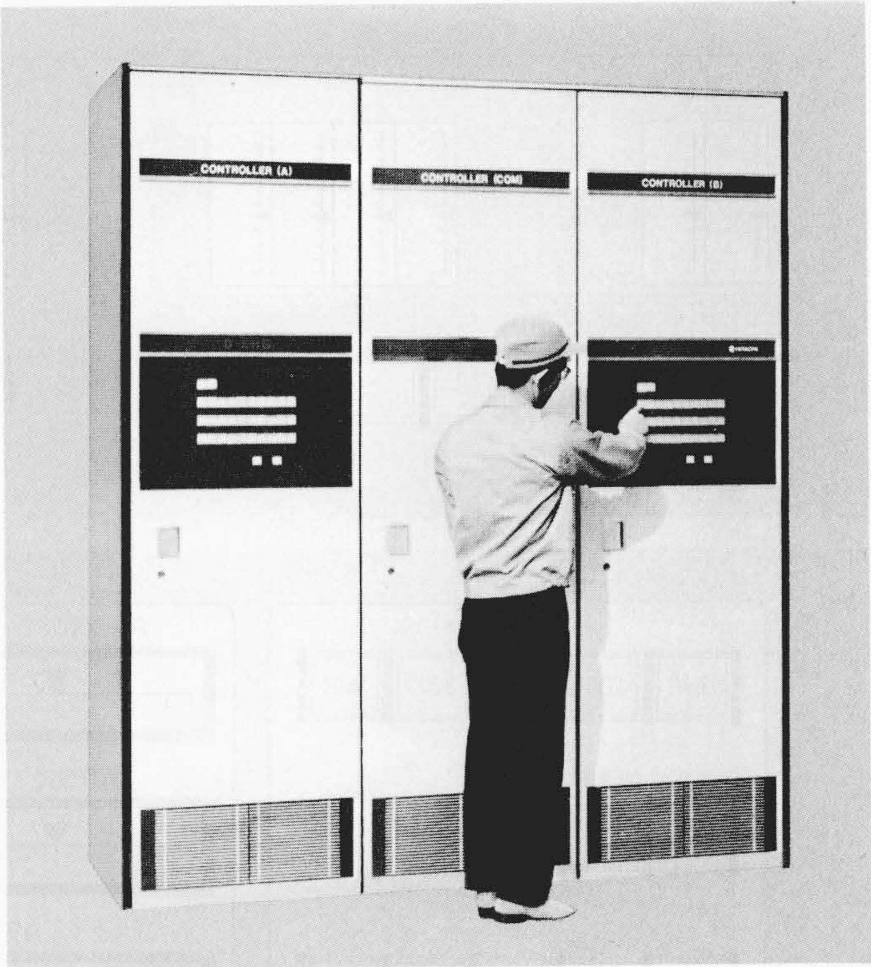
図3 D-EHGキュービクル キュービクルはA系、B系及び共通部の3面で構成される。
