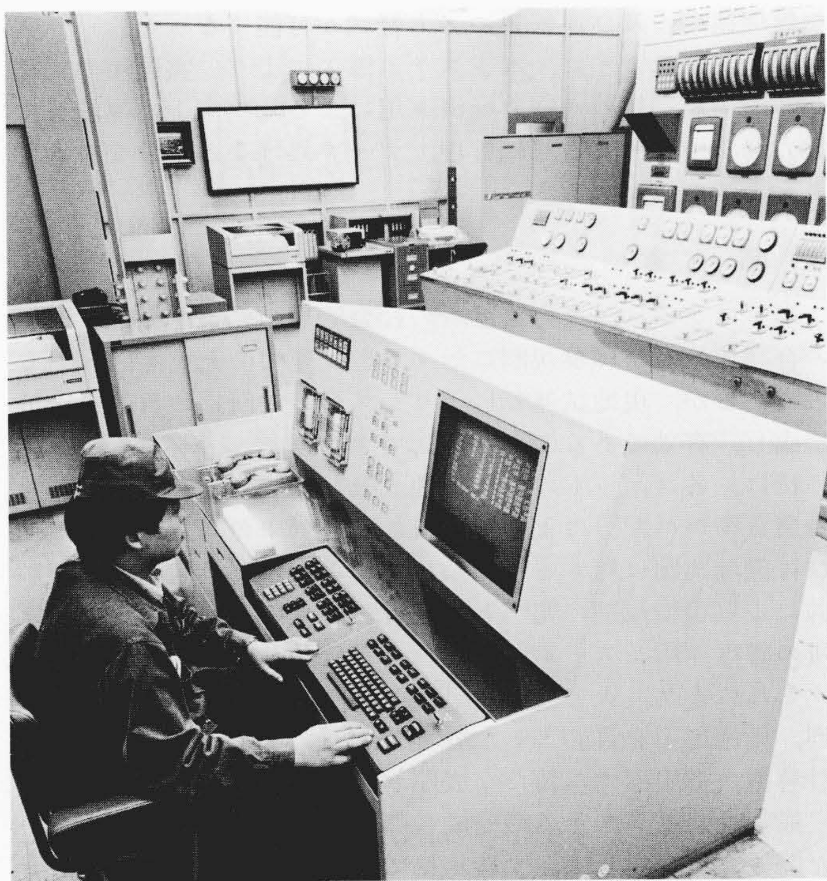
図5 オペレーターズコンソール概観 第1中央制御室設置のオペレーターズコンソールを示す。発電所の運用は、本オペレーターズコンソールを介して行なわれる。
