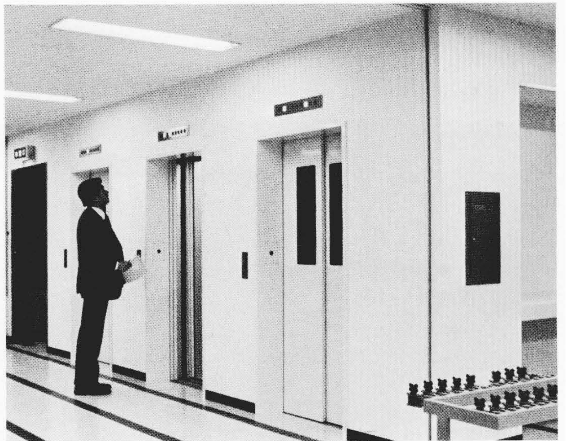
図11 稼動中のビルエースエレベーター
