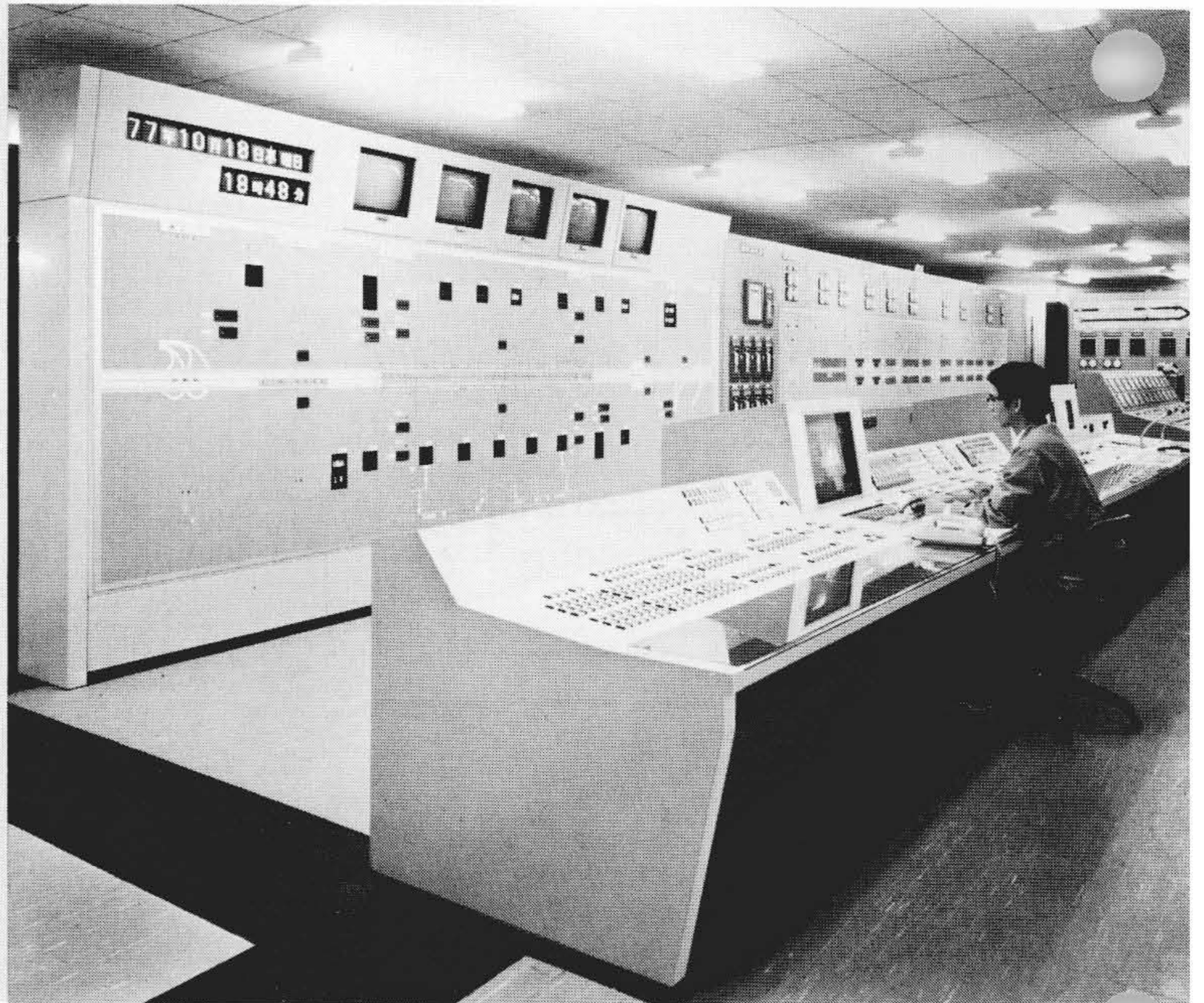
図23 日本道路公団中央自動車道(西宮線)大月管理事務所内コントロールセンター
