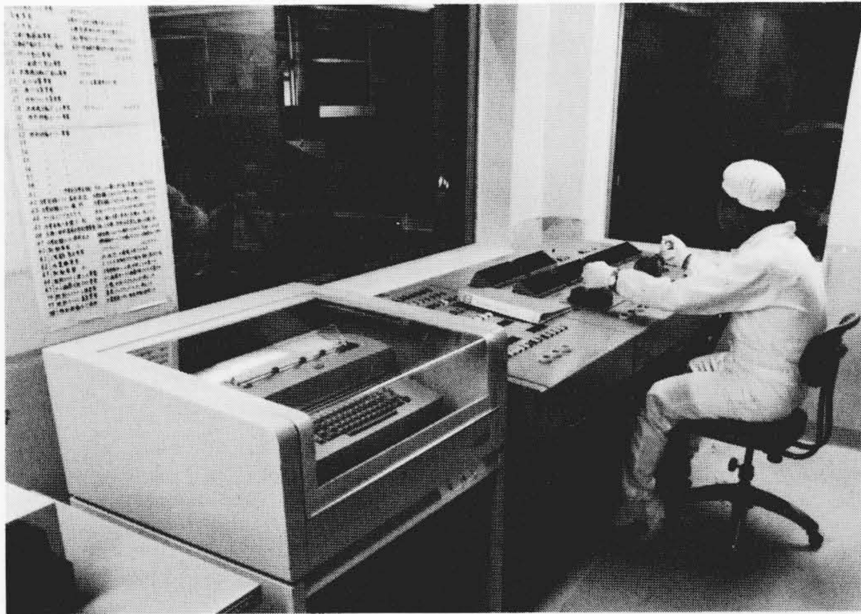
図5 遠隔制御室に設置された操作盤 この操作盤より、簡単な作業指令を与えることによって燃料移送が自動的に行なわれ、作業記録がタイプライタに打ち出される。
