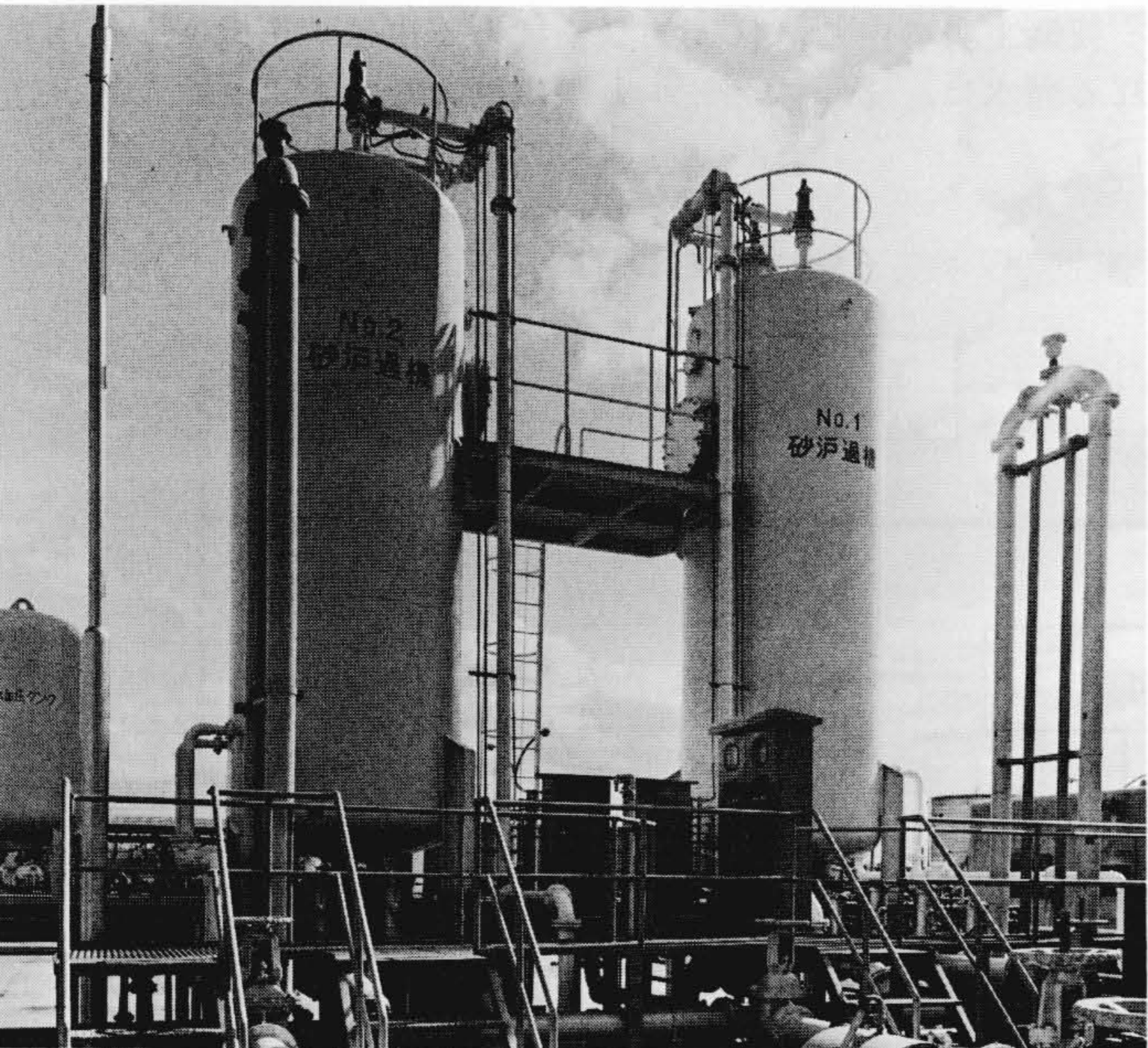
図9 装置の外観(3) 福岡県D下水処理場納入のもので、処理能力は60m 3 /h/基×2基である。
