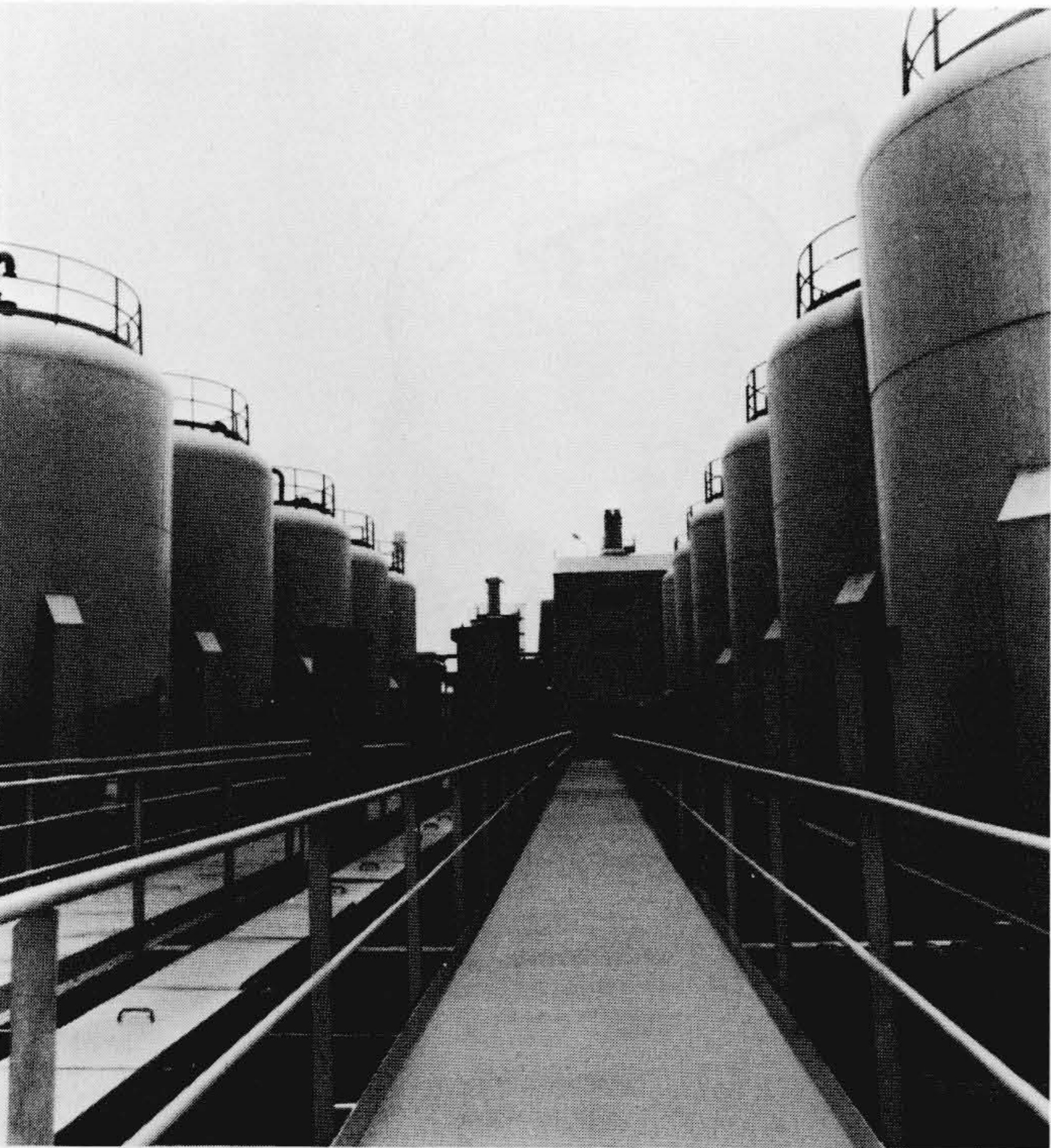
図8 装置の外観(2) 国外B社C製鉄所の圧延廃水処理用として納入したもので、処理能力は570m 3 /h/基×12基である。
