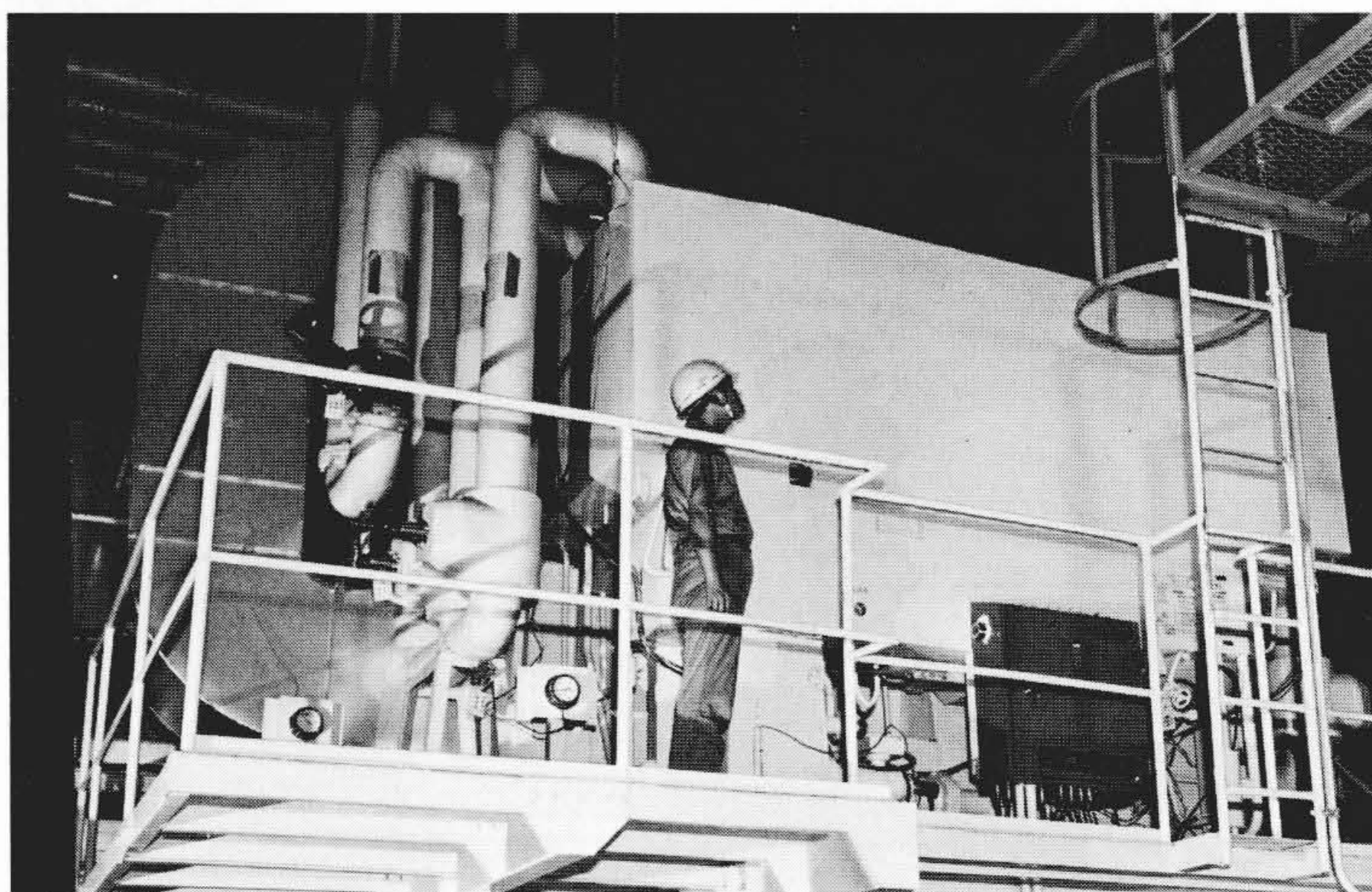
図8 排熱利用吸収式冷温水ユニット
