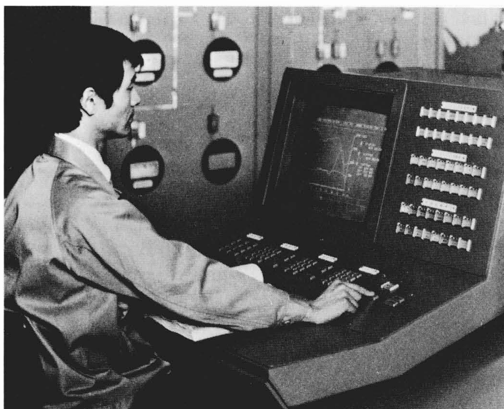
図6 オペレータズコンソール例 カラーディスプレイ装置を組み込んで、カラフルな図形、文字によりオペレータとのコミュニケーションツールとしている。
