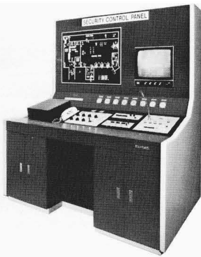
図11 無人化運転総合監視盤
