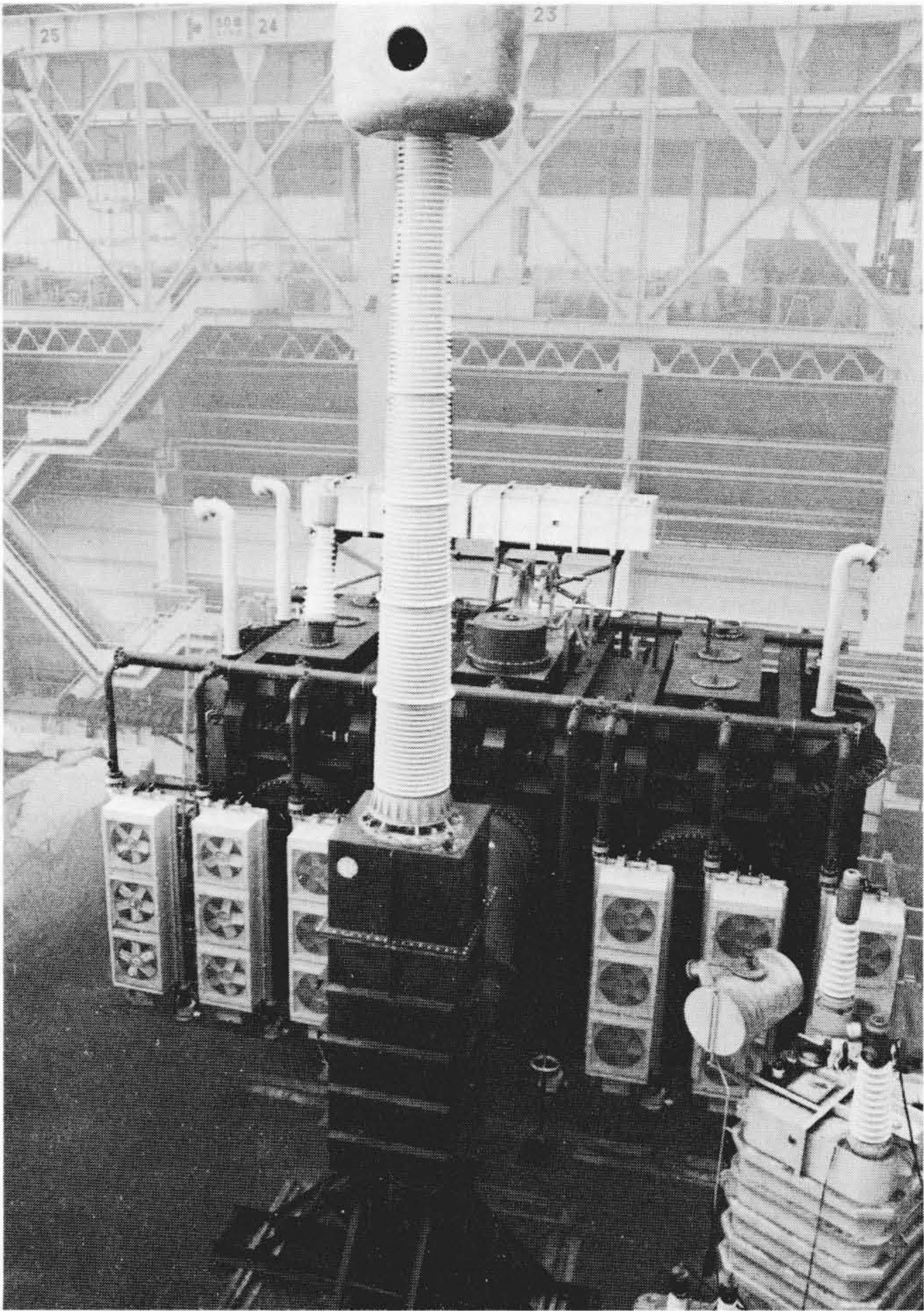
図 6 試作525kV 1,200MVA 実規模変圧器の試験 高圧側はケーブル直結構造であるが、工場試験時には高圧ブッシングを取り付けた。
