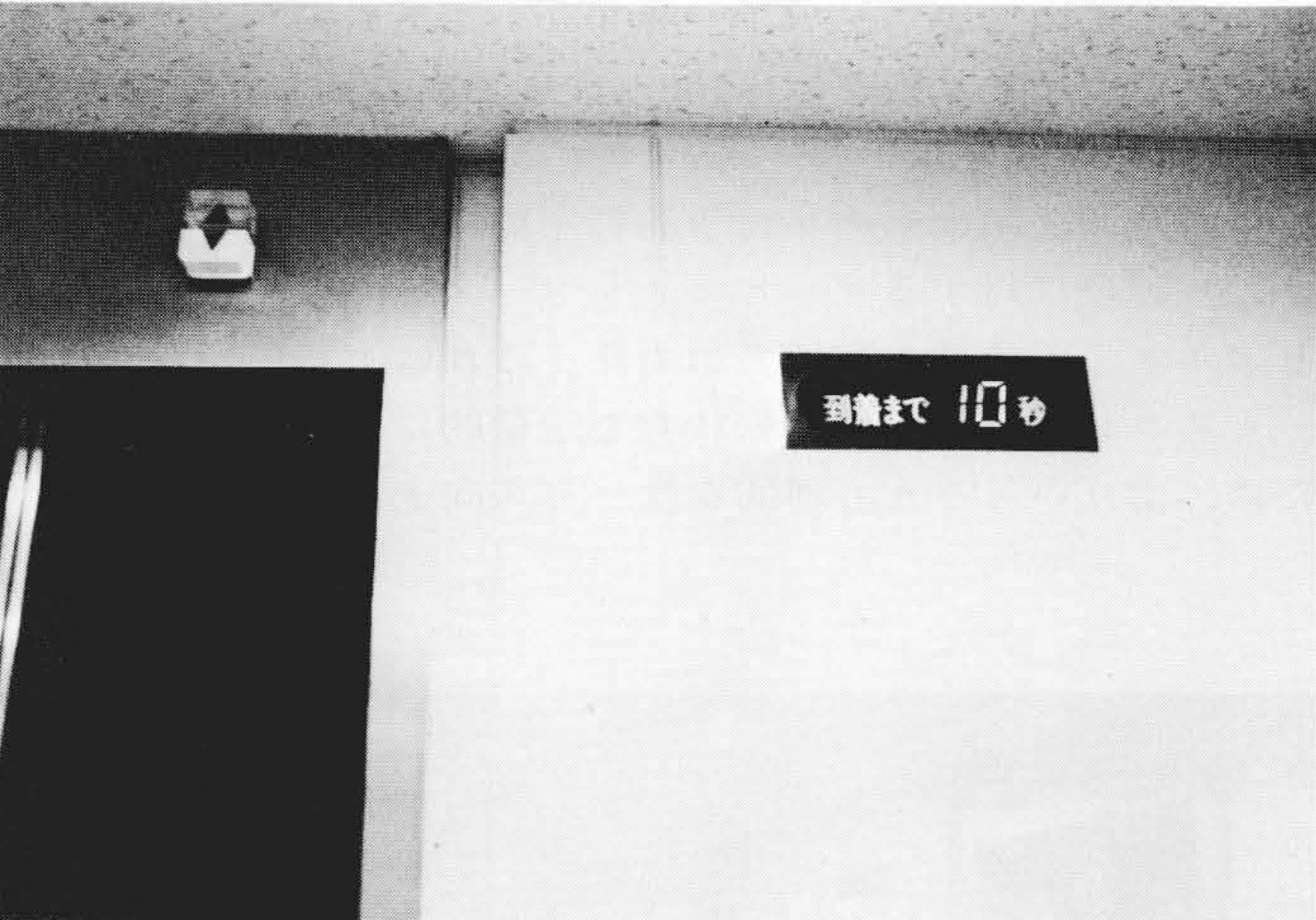
図6 待ち時間表示 待ち客に対して、サービスエレベーターがあと何秒で到着するかをリアルタイムで案内表示する。
