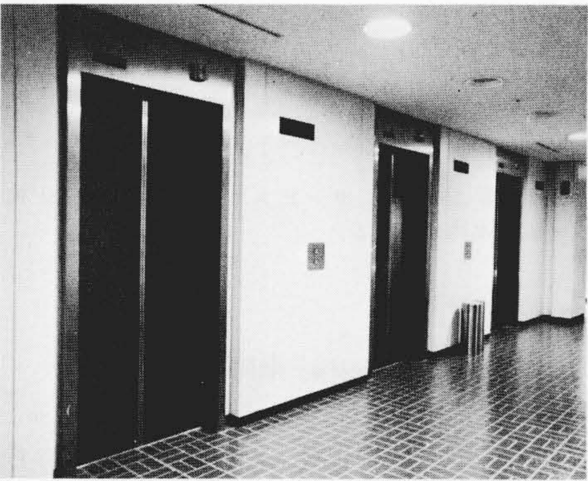
(a) エレベーターホールで、片側に3台のエレベーターが設置されている。
