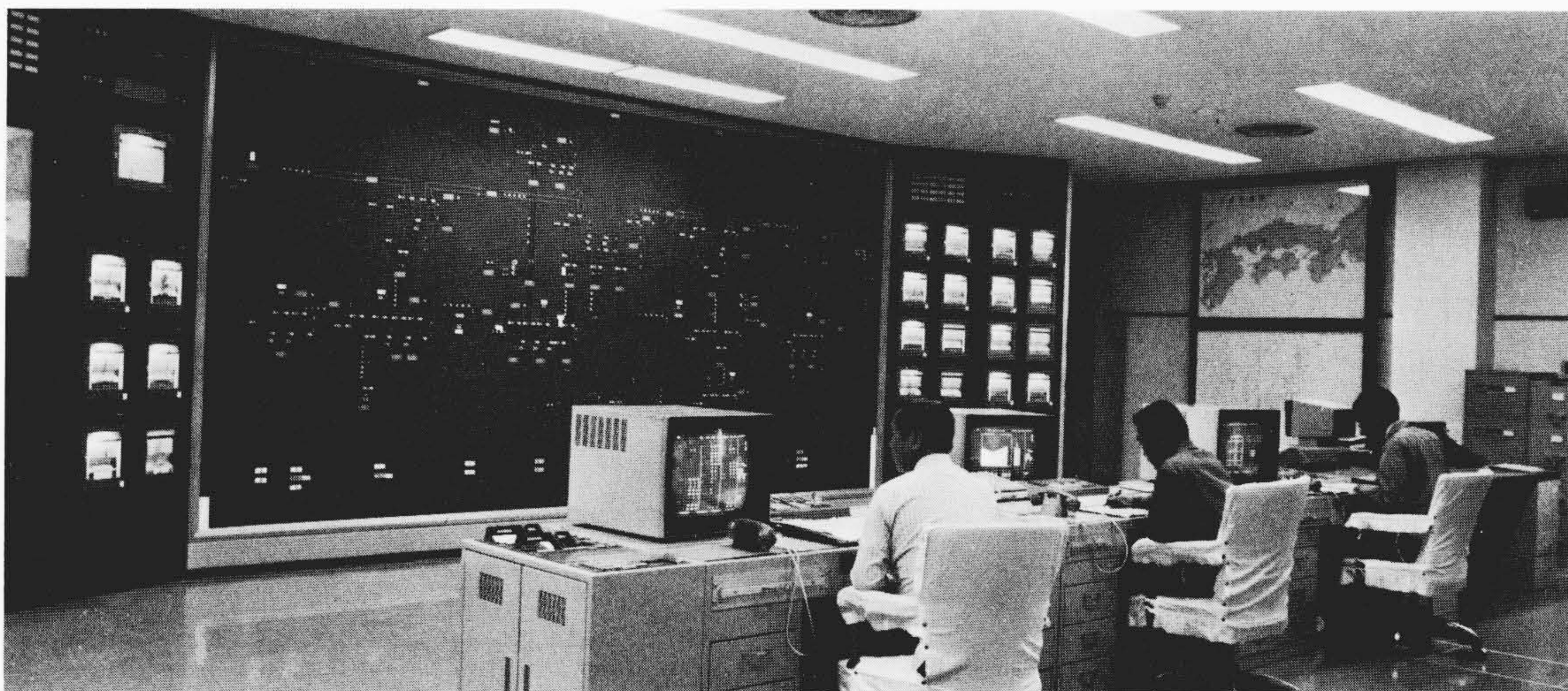
図2 中央給電指令所 指令室 系統盤では、 500kV 系統及び220kV 系統 を中心に表示し、110kV 系 統はCRTで詳細監視がで きるようになっている。
