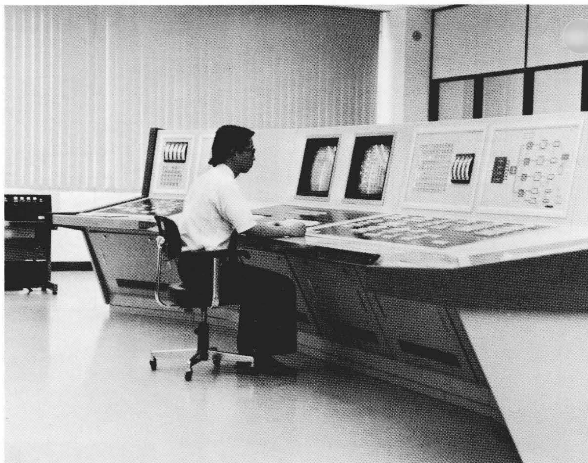
図1 北九州市曾根下水処理場納めCRT監視操作卓
