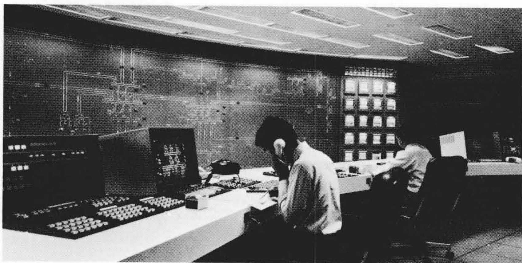
図6 秋田系統制御所監視制御室 室中央に制御卓を配置している。それぞれ右から監視制御卓、記録卓、監視システム卓と呼び、機能的に系統盤と調和したマンマシン設計としている。
