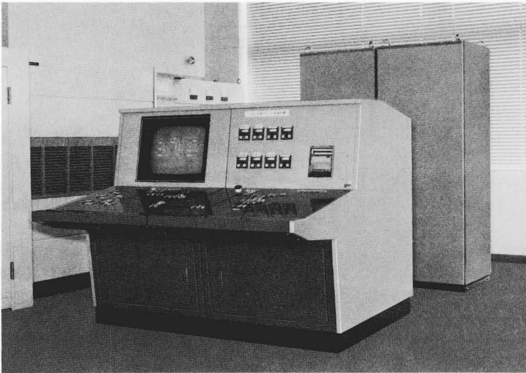
図9 監視制御装置の外観 コンソールはコンピュータを内蔵し、一連のプロセスを自動制御するとともに、プロセス動作状態を集約表示する。また、人間工学的に十分配慮した機能・形状・寸法としている。
