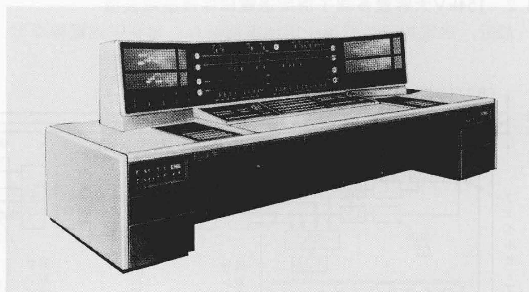
図6 デジタル形監視制御盤 系統の大規模化・複雑化に伴い、監視範囲が拡大し多種多量の情報を迅速かつ正確に把握するため、監視制御盤の論理部にマイクロコンピュータを用いるケースが出ている。
