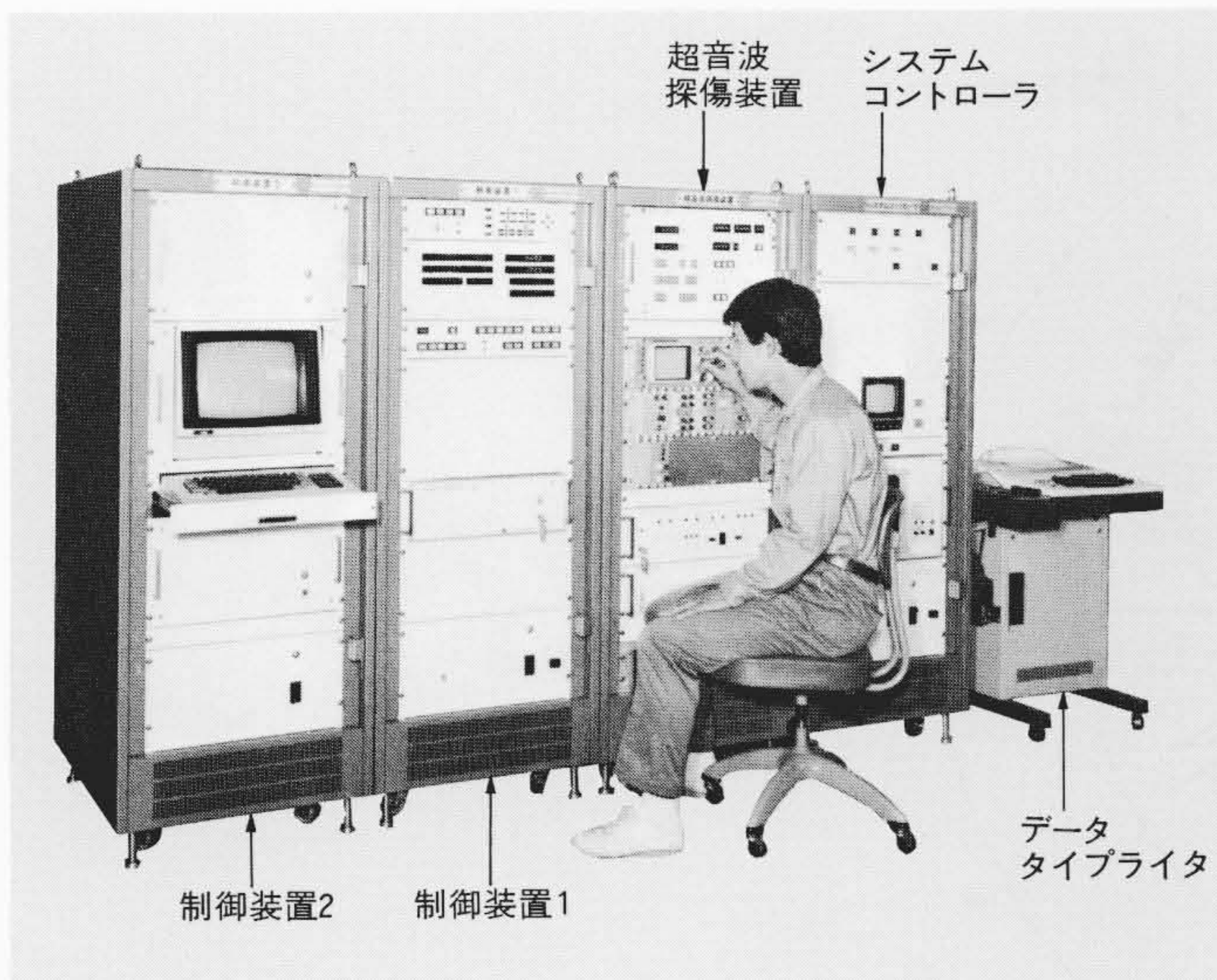
図9 圧力容器用制御装置及びデータ収録装置 左から圧力容器用制御装置2及び1, 超音波探傷装置, システムコントローラ, 並びにデータタイプライタを示す。
