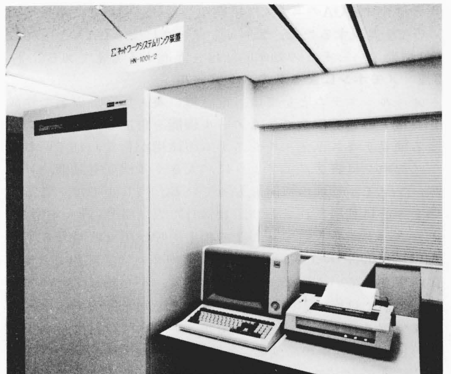
図6 マスタリンク装置と監視端末 1台で最大64回線を収容できるマスタリンク装置と、Σネットワークの運転状況を管理する監視端末を示す。
