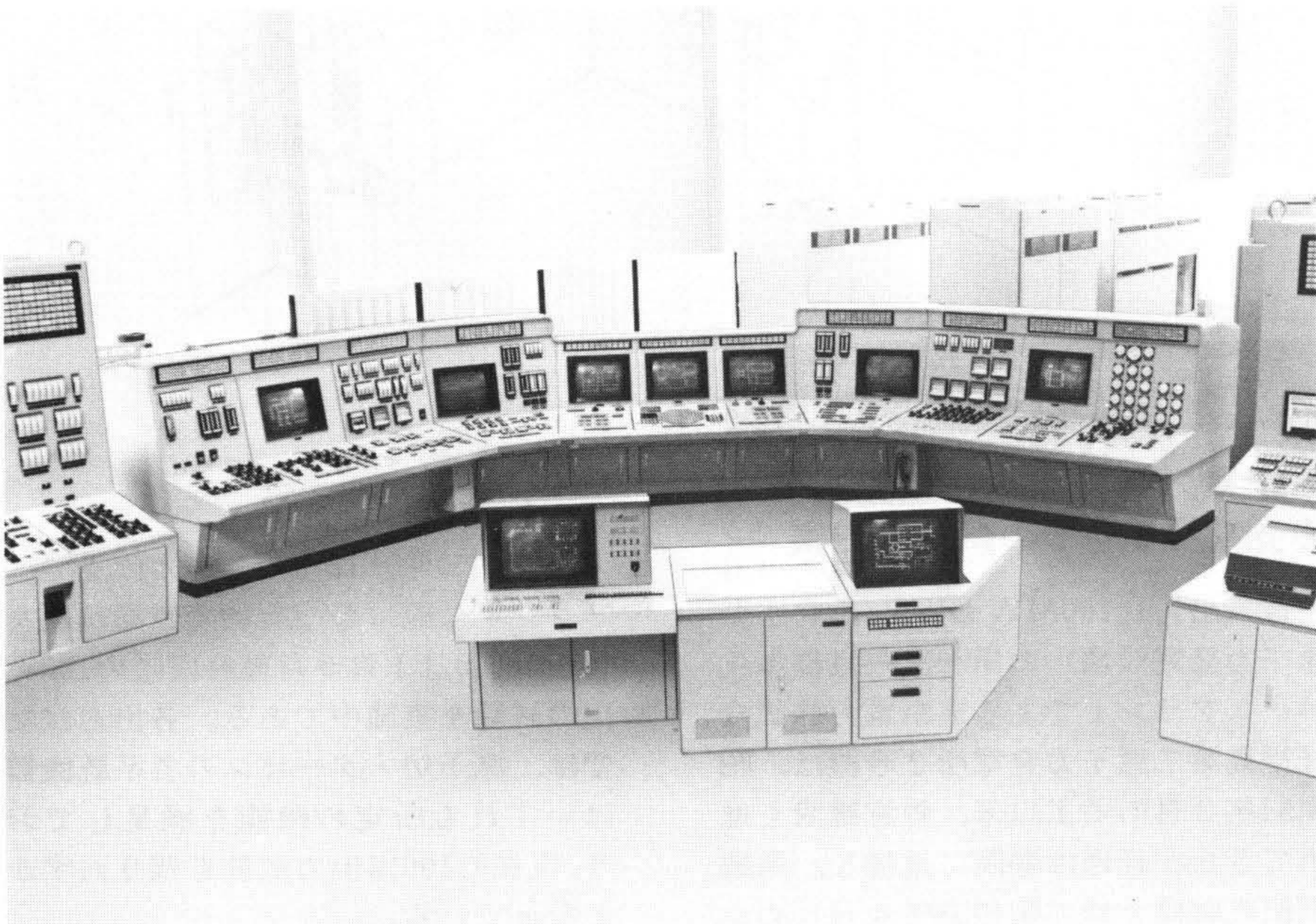
図 4 東京電力株式会社福島第二原子力発電所 4 号機用オペレータコンソール
