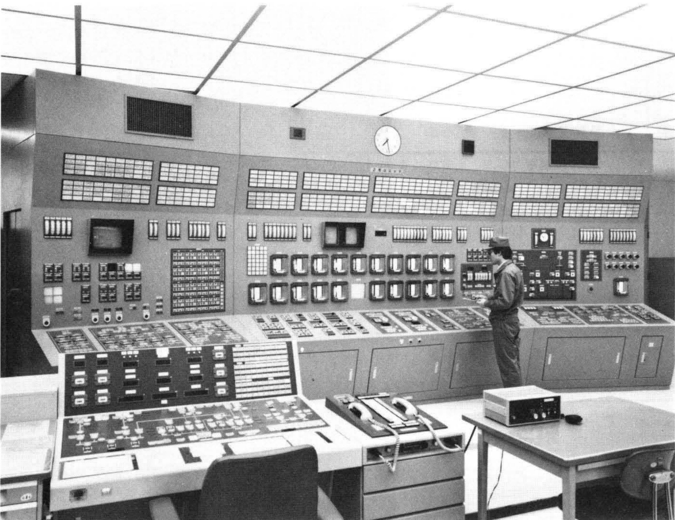
図23 関西電力株式会社御坊発電所2号機中央制御盤
