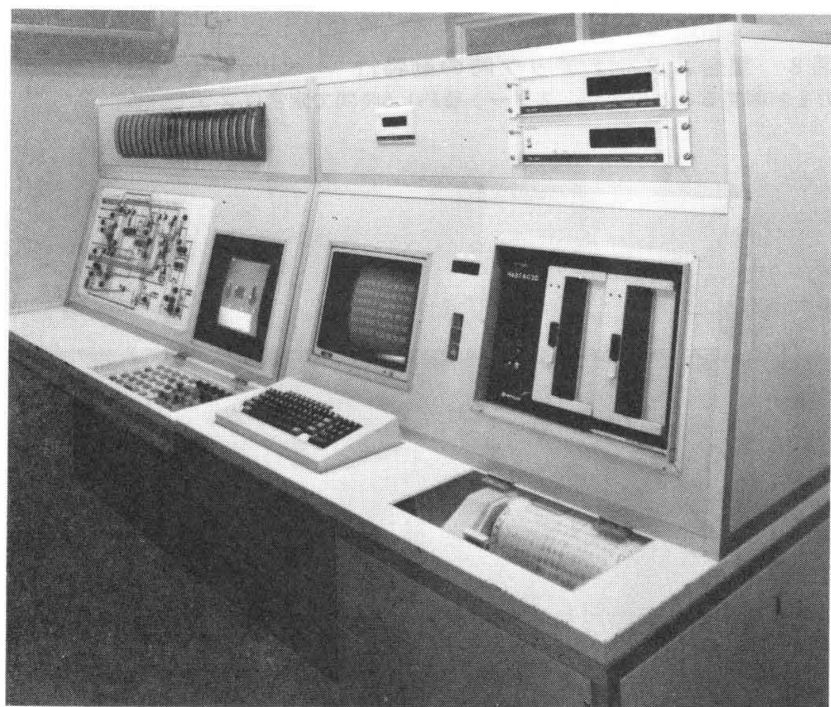
図7 スチレン塊状重合装置用制御装置 パイロットプラントに用いた制御盤であり、グラフィックパネル、グラフィックディスプレイ、プリンタなどで構成している。
