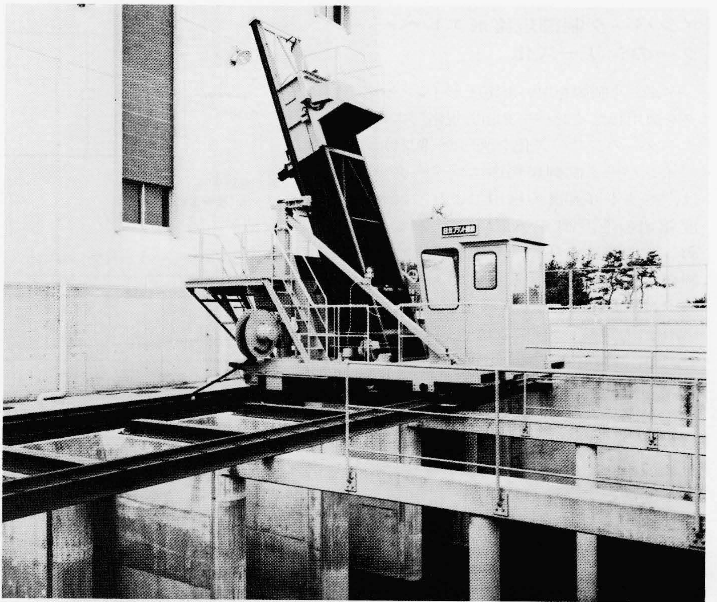
図22 伊予市大谷ポンプ場納め「日立走行式ハイチェーン」の外観
