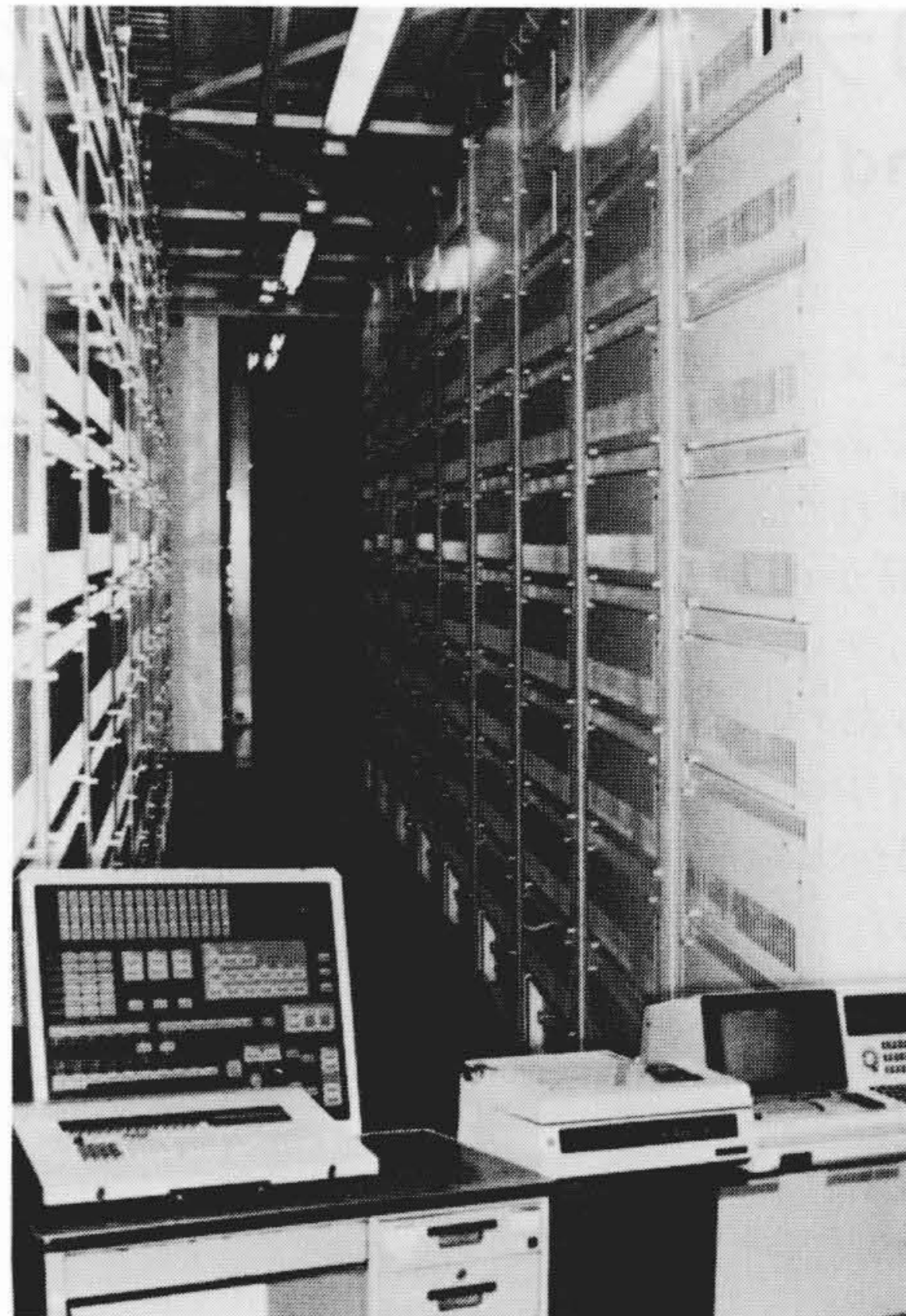
図2 D70交換機 1万加入者を收容する局は、約20架で構成される。架の大きさは幅0.65m、奥行0.45m、高さ2.75mである。
