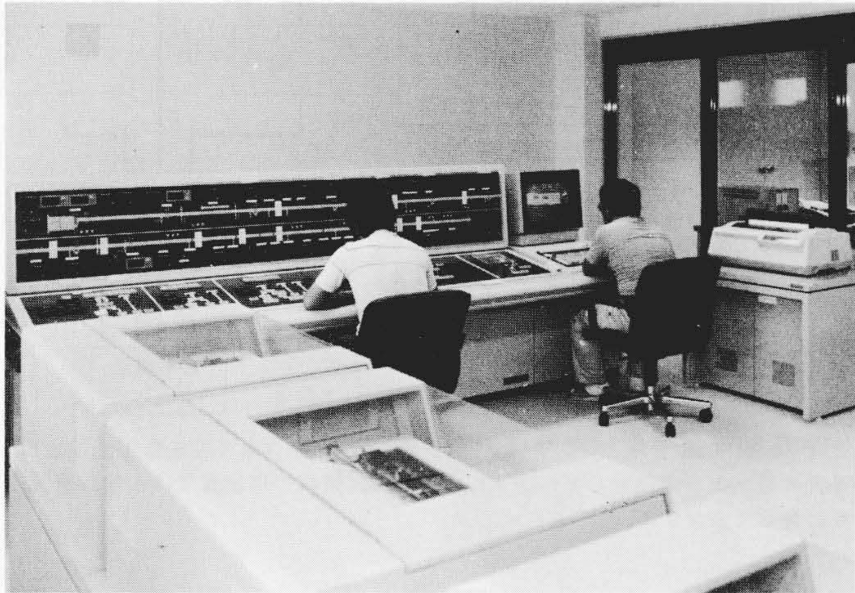
図5 中央管理所操作室 需要分水量の入力からゲート操作まで、全用水区間の監視、制御をこの操作室で行なっている。ミニグラフィックパネルは、水路を2分割配置としている。
