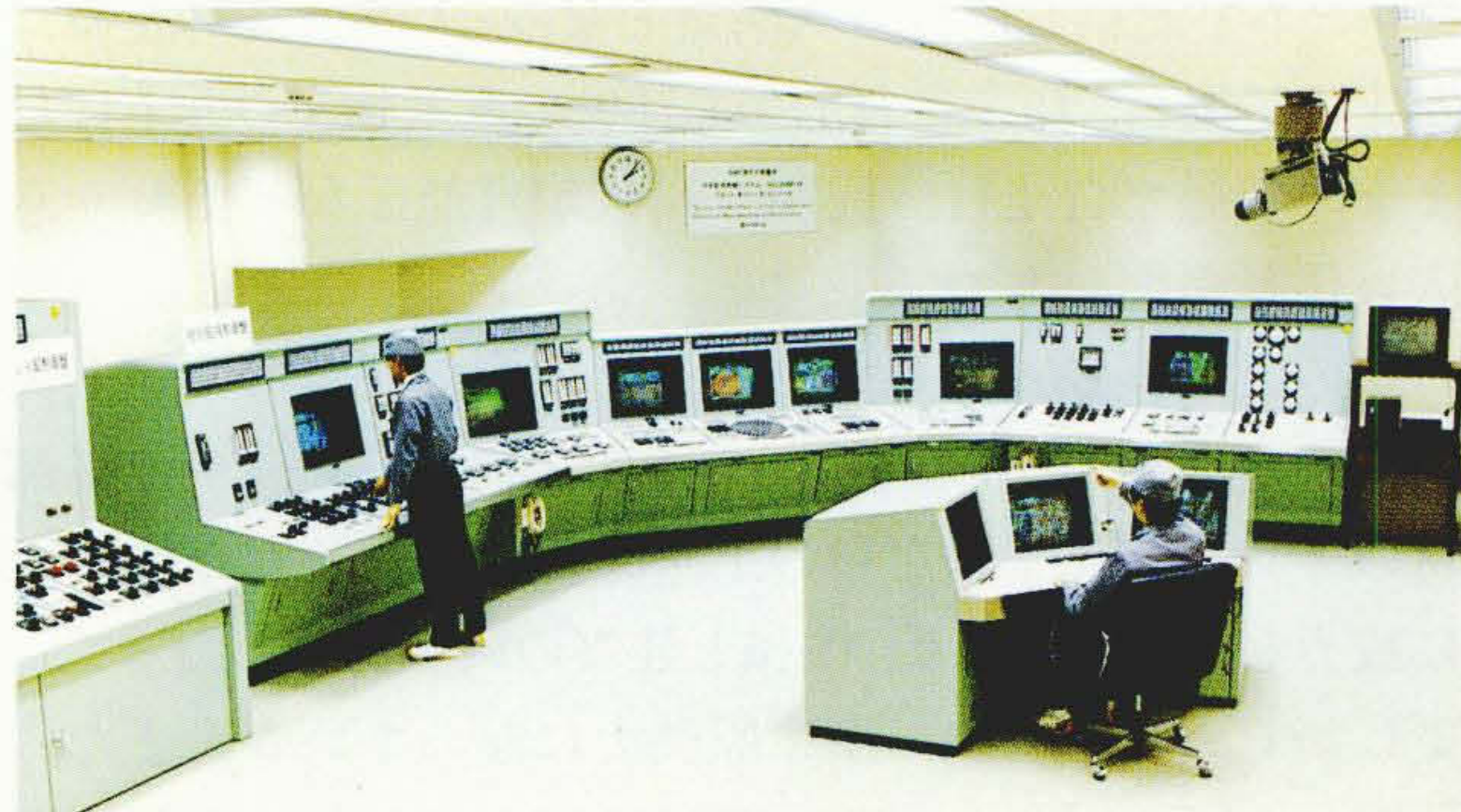
インストラクションシステムが組み込まれた新形中央監視制御システム
