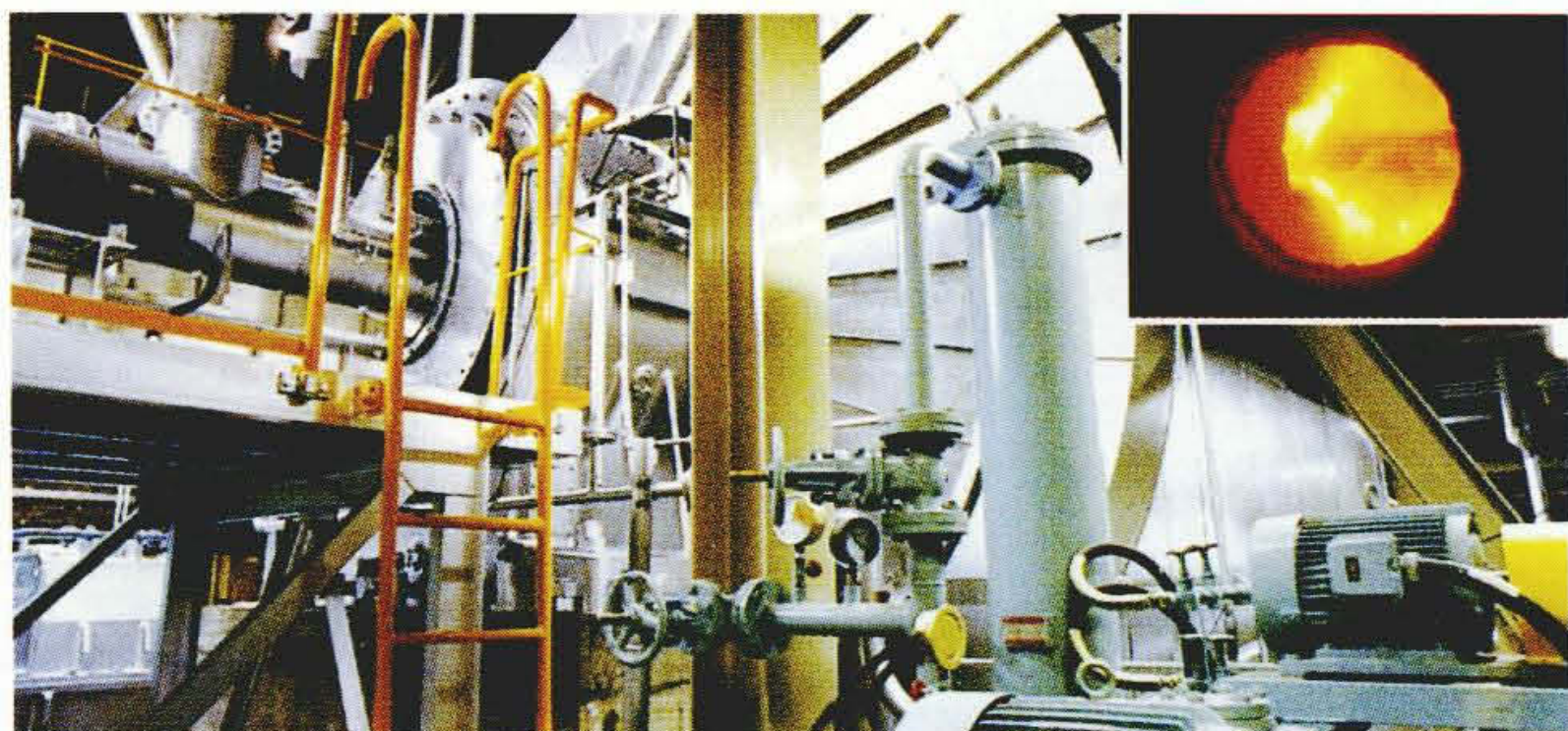
常磐共同火力株式会社勿来発電所で実機試験中のCWM 製造能力15t/hのボールミルとCWMの燃焼状況(右上)
