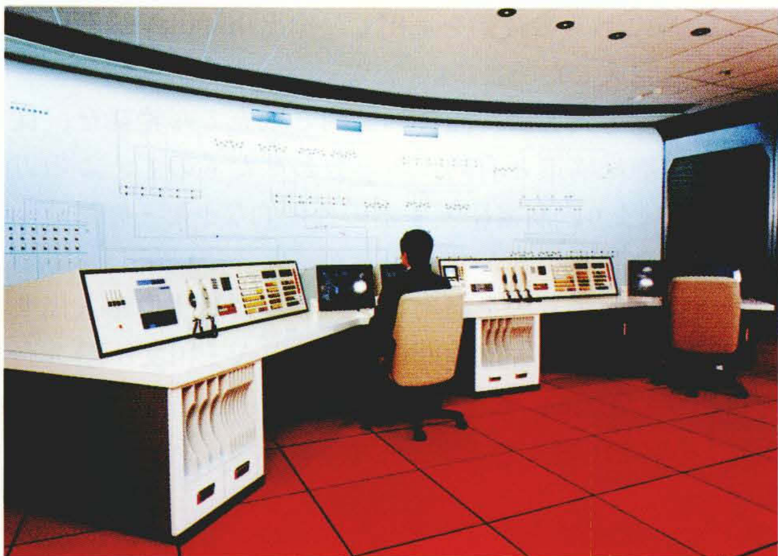
運用を開始した自動給電システム HIDIC V90/50を使用した二重系システムで、香港島全域の発電、送電、配電を監視制御する
